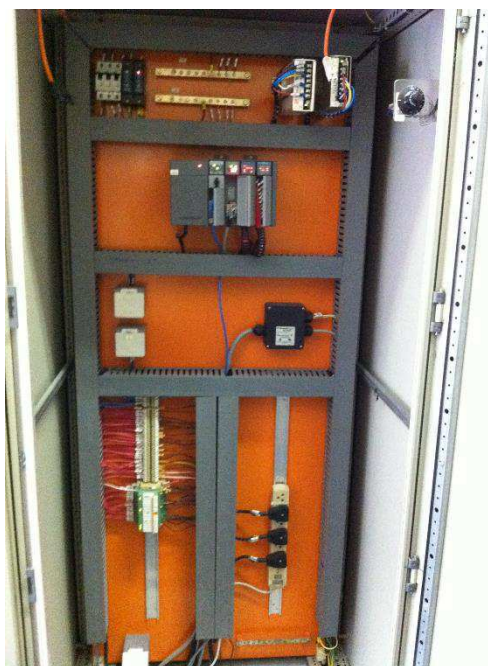
Figura 9 - Painel Elétrico de um CLP SLC 500® da Rockwell com um módulo DeviceNet.
