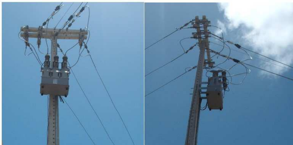
Figura 3.9: Sistema de medição 15 kV instalado
