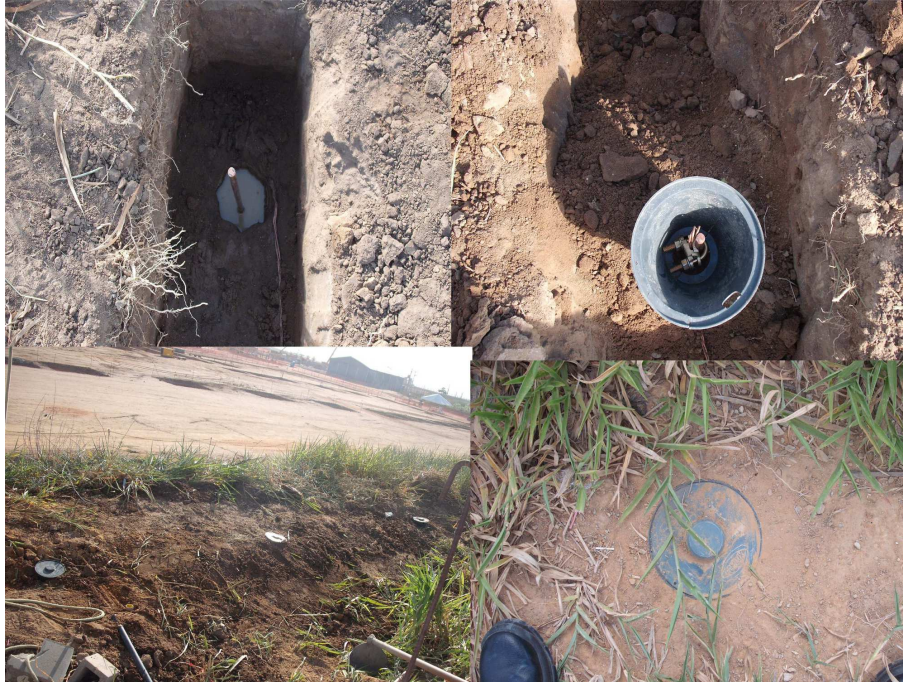
Figura 2.10: Aterramento da SE de 300 kV.
