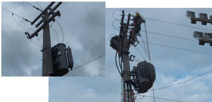
Figura 2.15: Transformadores de 112,5 e 300 kVA utilizados na rede MT.
