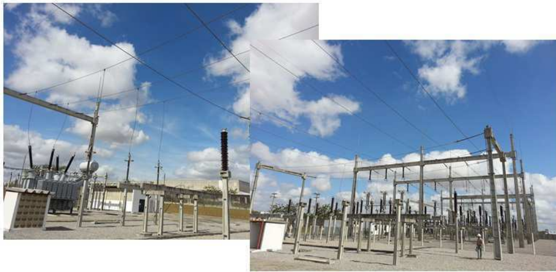
Figura 3.3: Visita técnica a SE 230/13,8 kV - Coteminas
