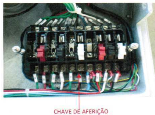
Figura 3.7: Conjunto de medição trifásico: Chave de aferição
