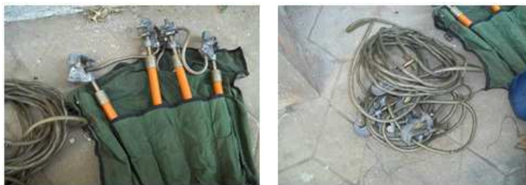
Figura 2.30: Conjunto de aterramento de BT e conjunto de aterramento de MT.
