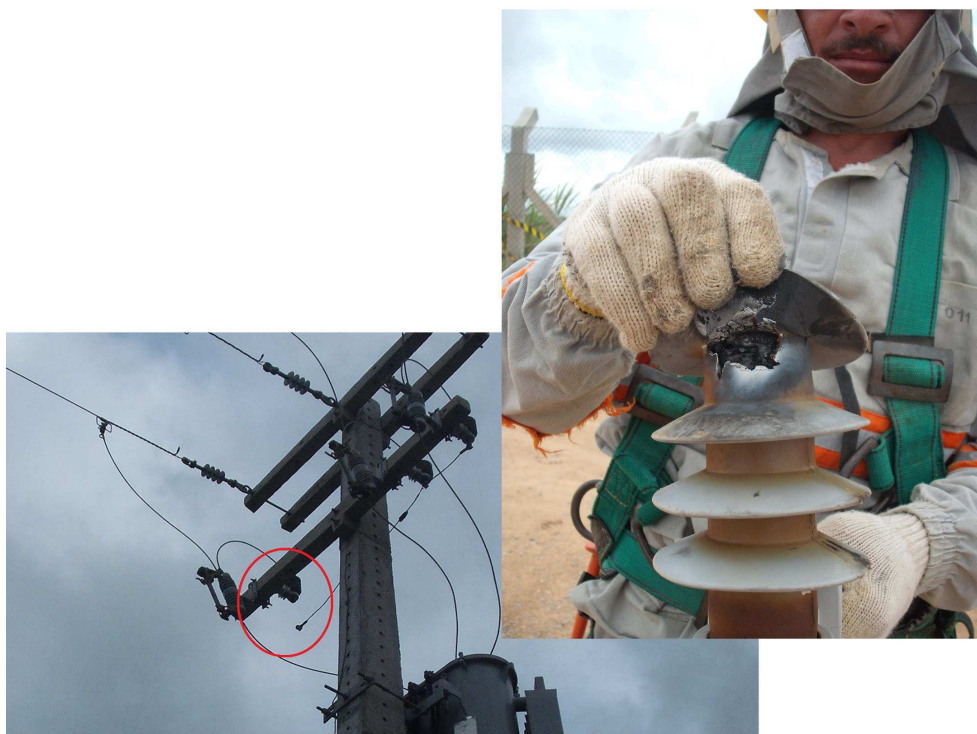
Figura 2.19: Para-raios de 15 kV danificado.
