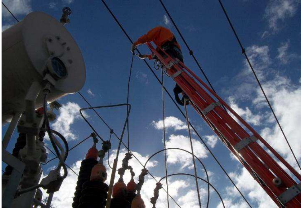
Figura 34: Desconexão do transformador 02T1-A de CGU
