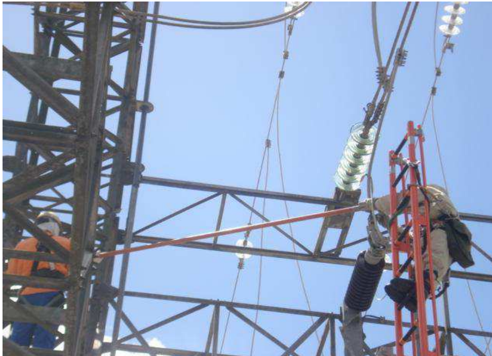
Figura 15: Eletricista ao potencial utilizando a skyladder e um eletricista de apoio na estrutura
