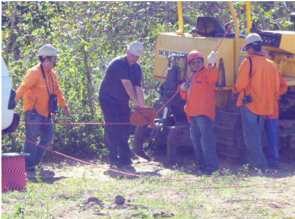
Figura 20: Arriamento de cabo para-raio (parte de solo)
