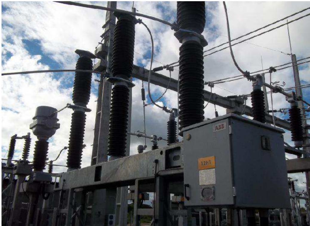
Figura 22: Foto do disjuntor ABB LTB 145 em SRD
