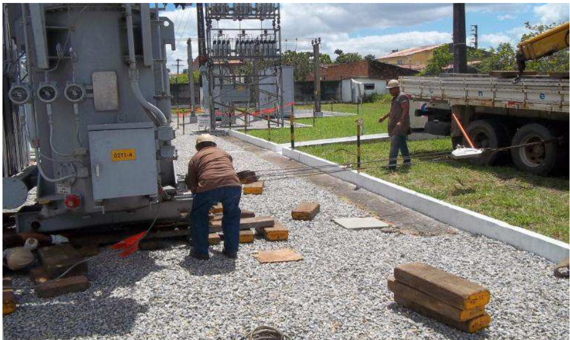
Figura 38: Deslocamento do transformador 02T1-A em CGU
