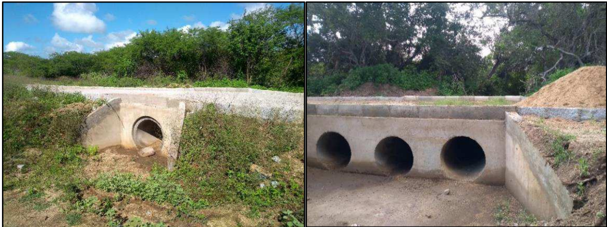
Figura 11 - Passagens molhadas na estrada de acesso a Usina de Alimentos
