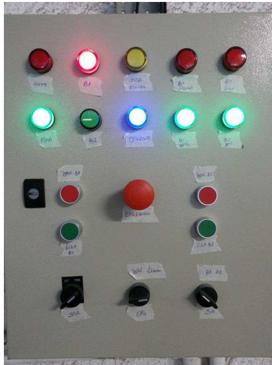
Figura 2.3: Quadro de comando
