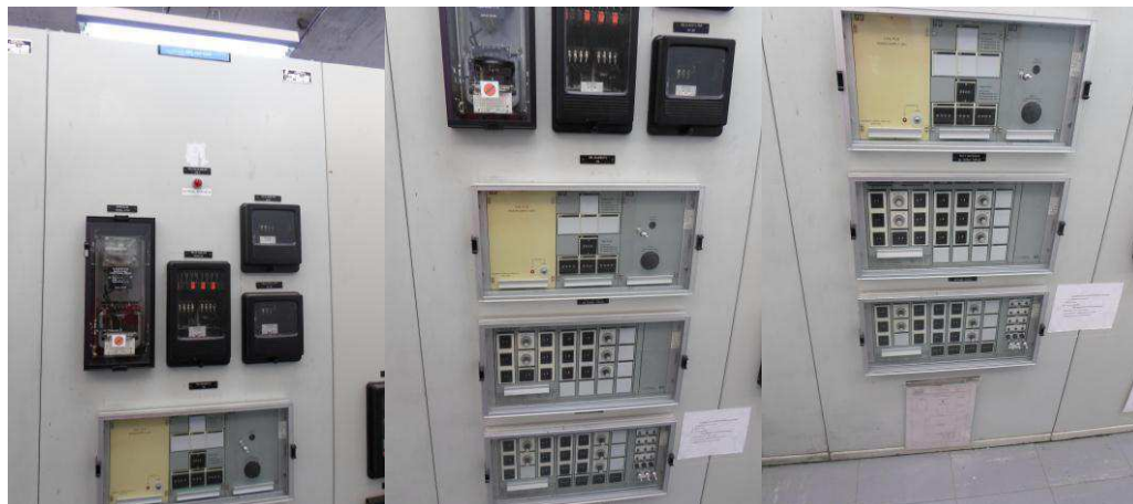
Figura 1: Relé de Proteção Eletromecânico (Acervo da Interest Engenharia)
