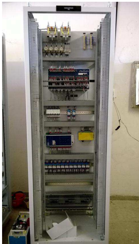
Figura 21: Painel de Proteção - Link de Geração
