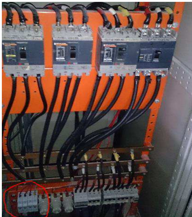
Figura 3. 7. - DPS instalados em quadro QGBT da Zincagem
