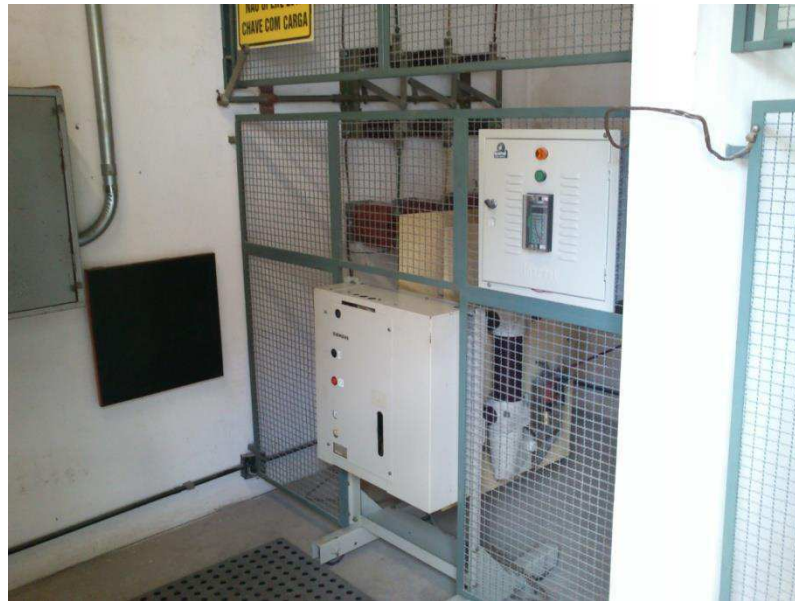
Figura 3. 4. – Disjuntor instalado na Subestação 02
