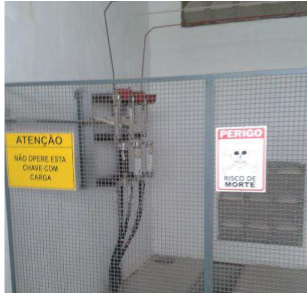
Figura 3. 13. – Sinalização nas Subestações.
