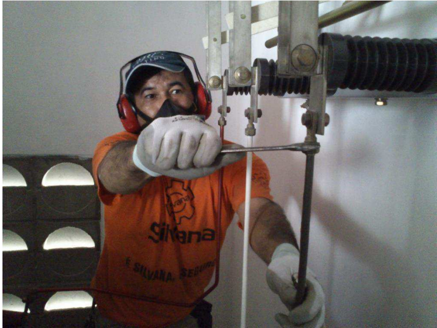
Figura 3. 2. – Fotografia de um técnico realizando Manutenção Preventiva Fonte: Acervo próprio do autor
