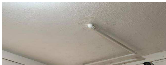
Figura 3: Teto e parede área de vendas do MERC 2.
