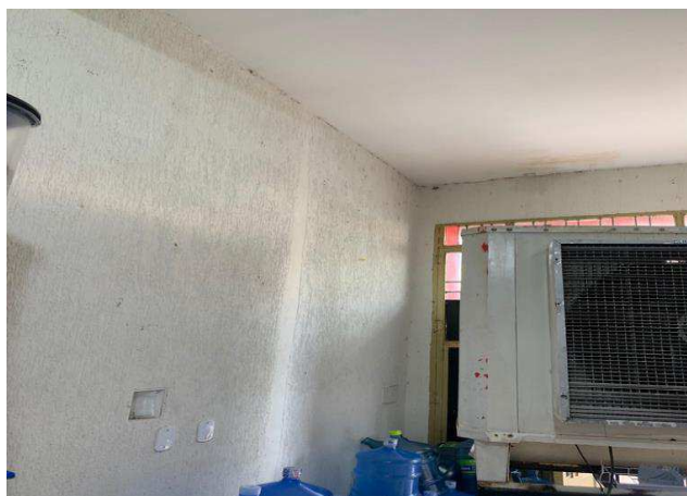
Figura 4: Teto e parede área de vendas do MERC 3
