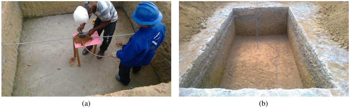
Figura 7. (a) Execução de uma solda exotérmica para desvio da malha de terra na escavação para base do disjuntor de 230 kV. (b) Escavação com desvio na malha de terra para base do disjuntor de 138 kV.
