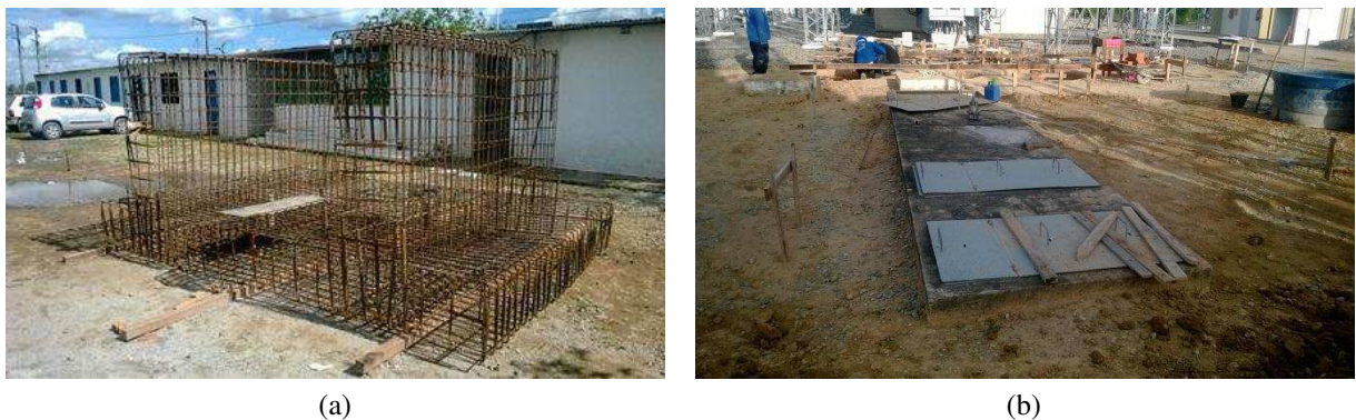
Figura 12. (a) Armagem da base do transformador. (b) CSAO existente no local de construção da base do transformador.
