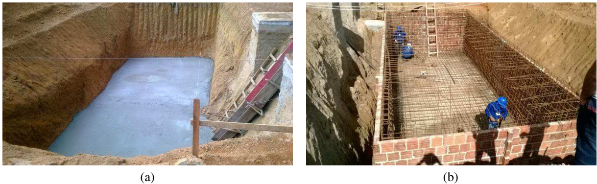
Figura 13. (a) Concreto magro da CSAO. (b) Forma em alvenaria e armação da CSAO.
