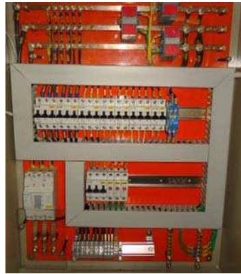
Figura 3.1 - Exemplo de Quadro de Distribuição Fonte: mlpainéis.com.br
