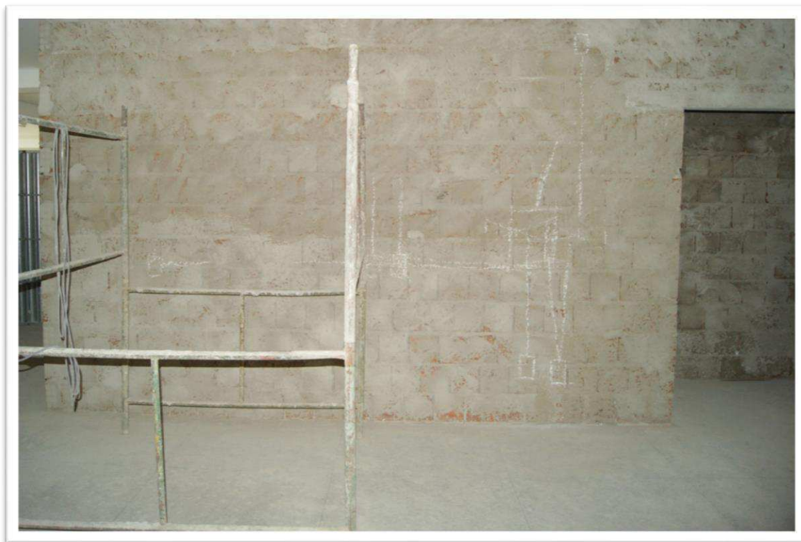
Figura 2 – Caminho de eletrodutos e tomadas.
