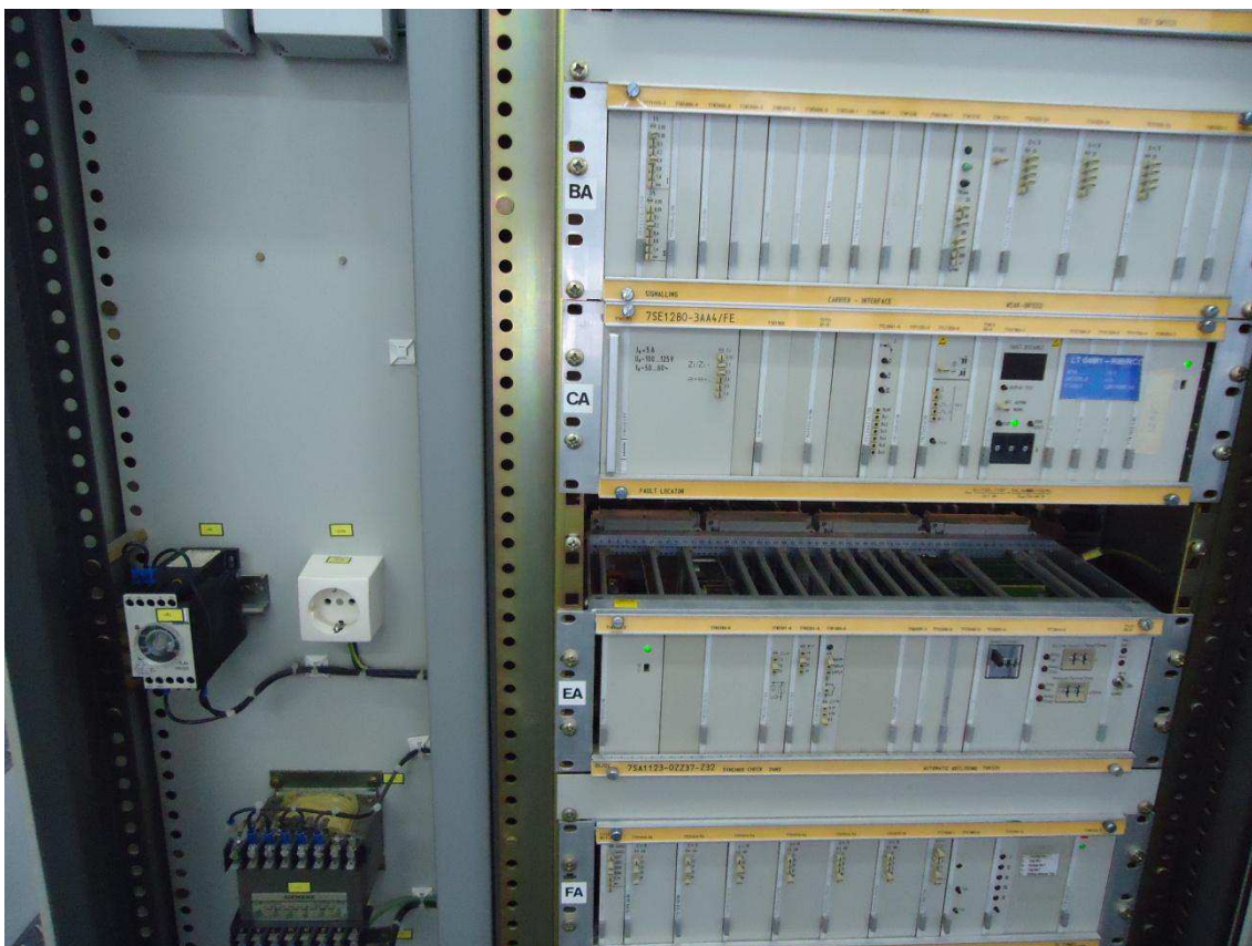
Figura 15. Painel CP2 da proteção 7SL32 da linha 04S1 da SE RIB.
