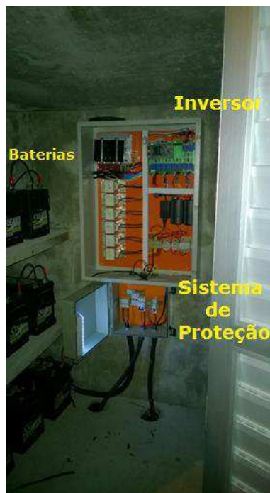
Figura 5.1 – Fotografia da parte interna do abrigo para inversor, sistema de proteção e conjunto de baterias.
