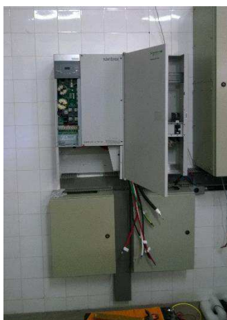
Figura 5.19 – Fotografia do processo de instalação elétrica do inversor instalado no Laboratório de Sistemas Fotovoltaicos da UFCG.
