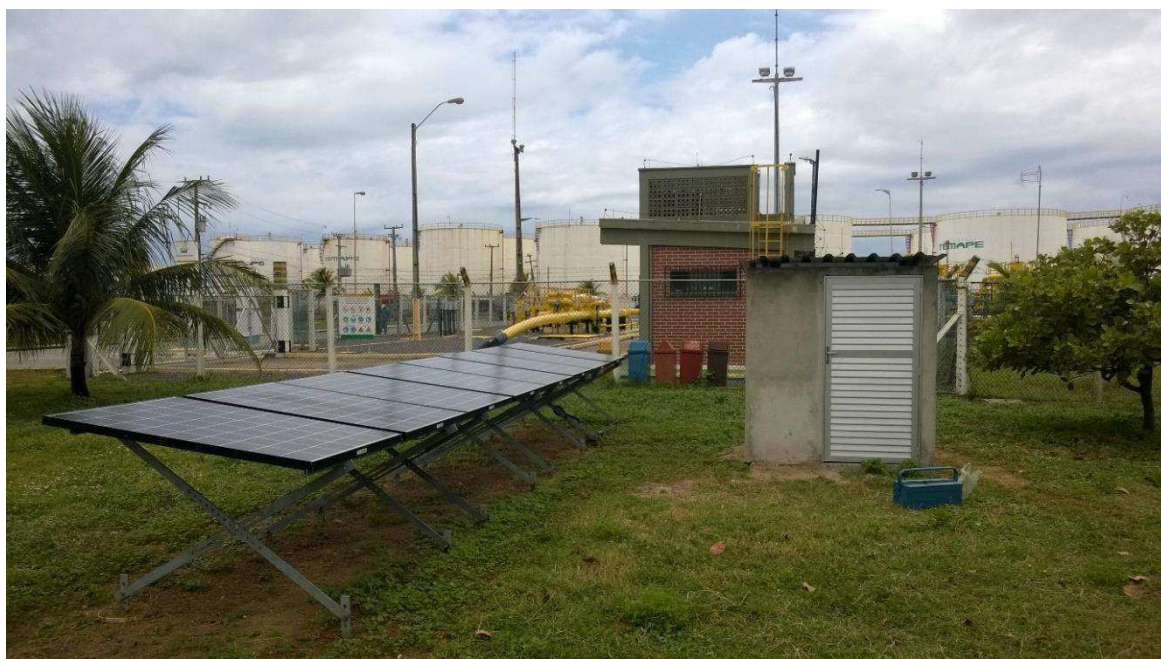
Figura 5.3 – Fotografia da visão geral de toda a instalação.
