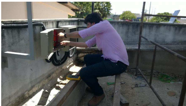
Figura 5.14 – Fotografia da verificação das tensões dos arranjos de painéis fotovoltaicos das plantas fixas no LEPER/UFRN.
