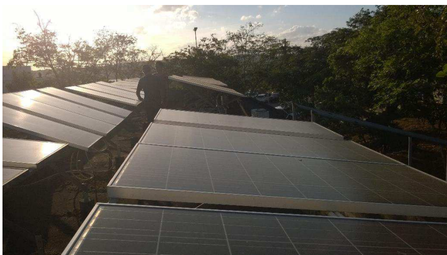
Figura 5.16 – Fotografia dos arranjos de painéis, a serem escolhidos, para serem conectados ao inversor instalado no Laboratório de Sistemas Fotovoltaicos da UFCG.
