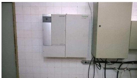
Figura 5.18 – Fotografia do inversor instalado no Laboratório de Sistemas Fotovoltaicos da UFCG.
