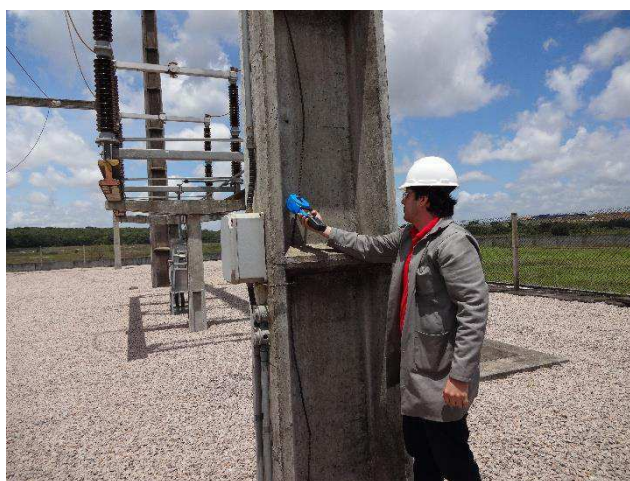
Figura 5.23 – Fotografia do processo de medição de resistência, utilizando alicate terrômetro, na SE Termonordeste da EPASA em João Pessoa - PB.
