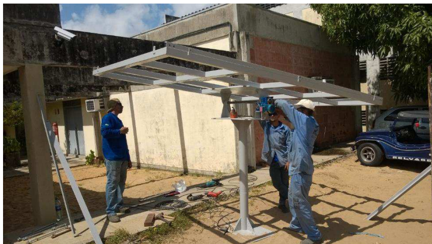
Figura 5.10 – Fotografia estrutura metálica de suporte do arranjo de painéis fotovoltaicos da planta rastreadora no LEPER/UFRN.
