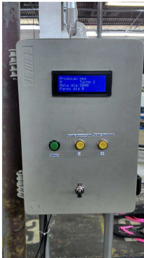
Figura 51: Visão geral do painel
