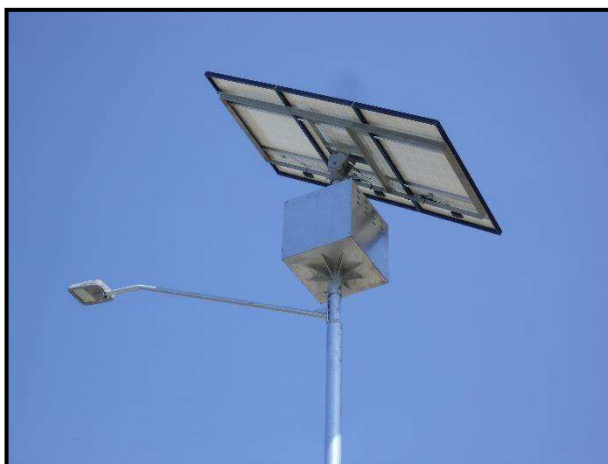
Figura 17 - Sistema completo de iluminação.
