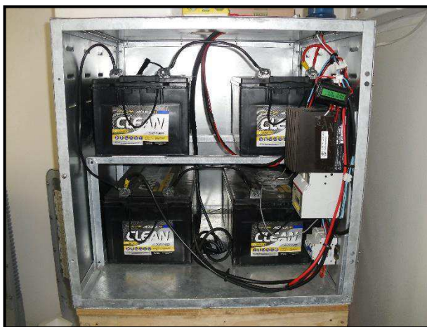
Figura 16 - Gabinete com baterias e controladores.
