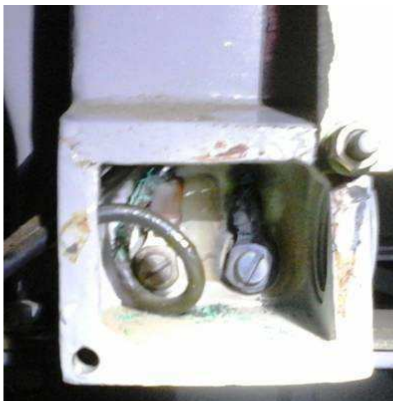
Figura 10 – TC defeituoso: folga no borne do secundário.
