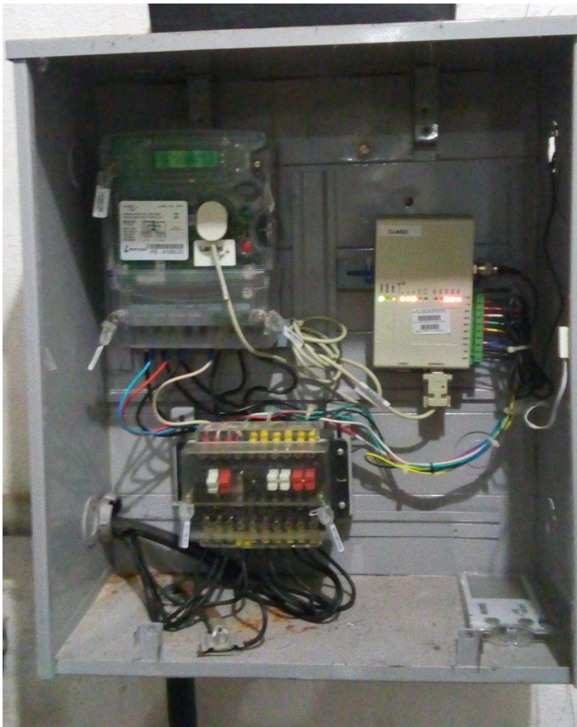
Figura 15 - Caixa de medição
