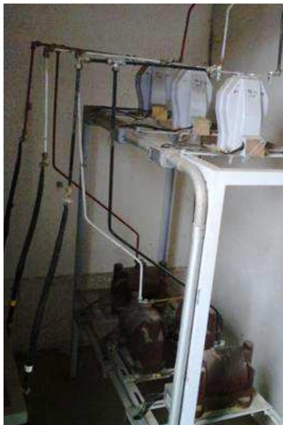
Figura 9 - Cubículo de medição do cliente com TC defeituoso.
