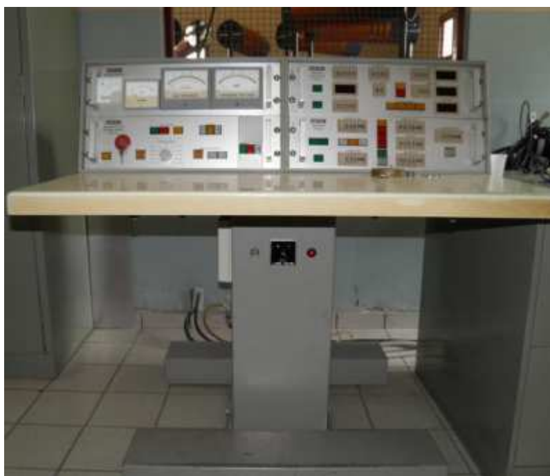
Figura 4.4 – Mesa de controle do gerador de impulso de corrente.
