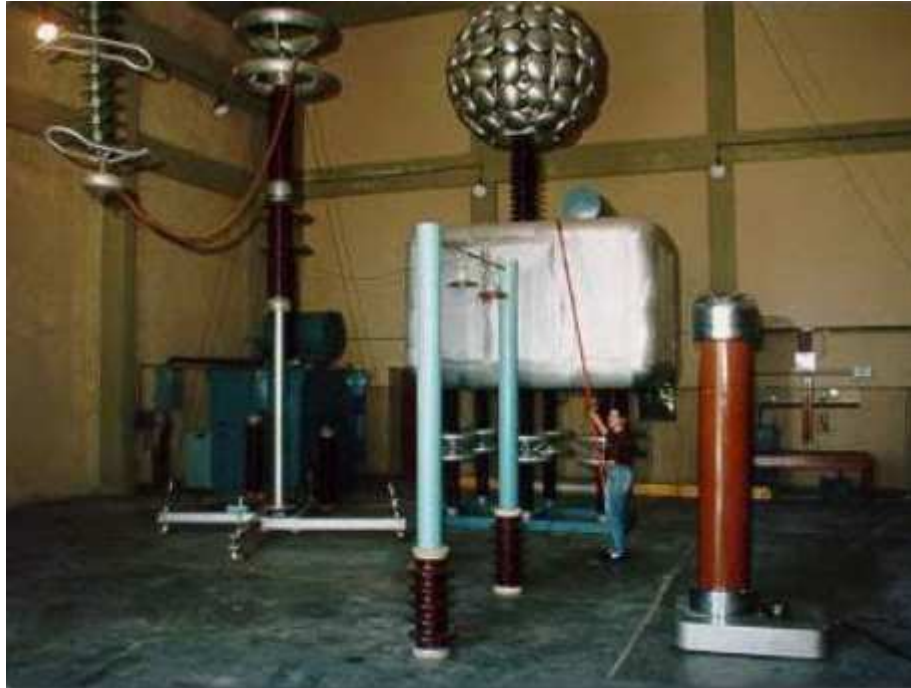
Figura 2.2 – Salão de Alta Tensão (GSE, 2015).
