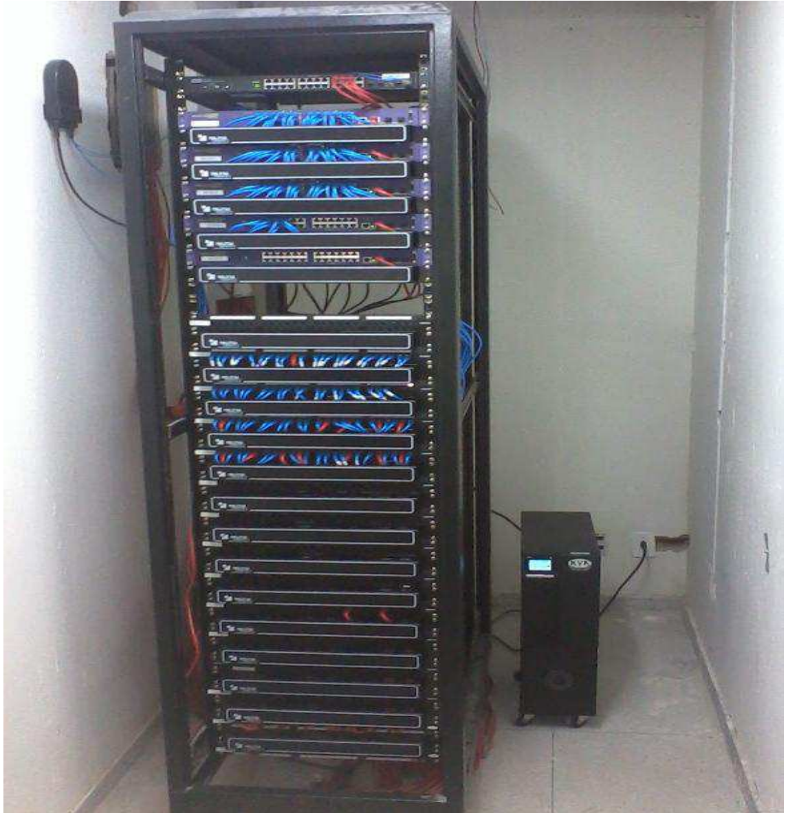
Figura 5: Outra sala de telecomunicações da Central de Aulas
