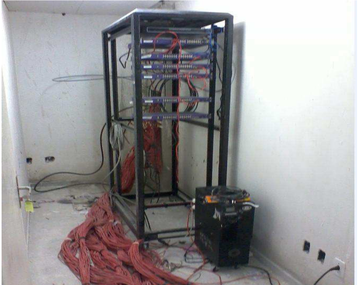
Figura 1: Sala de telecomunicações da Central de Aulas
