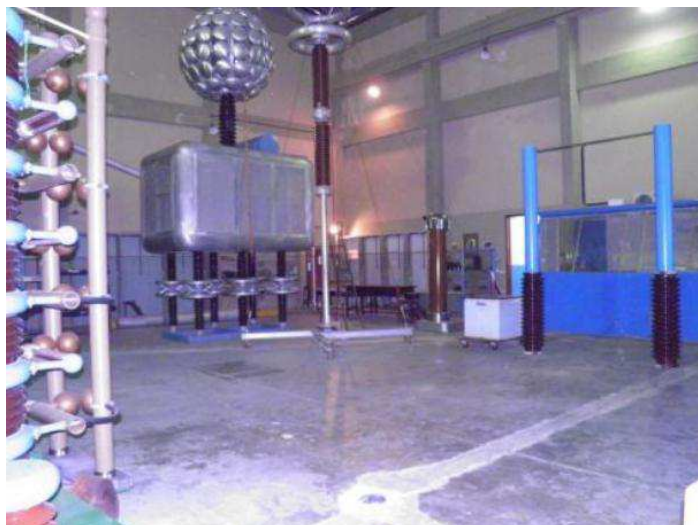
Figura 1: Salão de Alta Tensão
