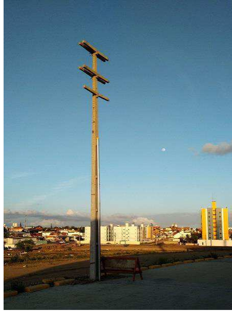
Figura 48 – Fotografia do poste de entrada do ramal de alta tensão.
