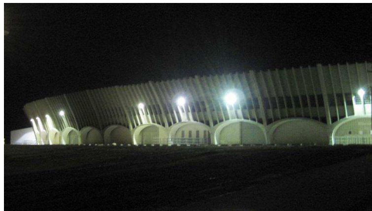
Figura 11 – Fotografia da lateral do estádio após a conclusão da instalação dos refletores de 400 W.
