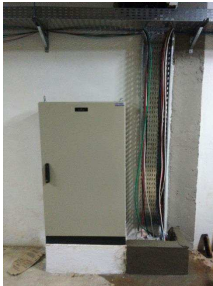
Figura 28 – Fotografia do Quadro de Distribuição Geral, QG.
