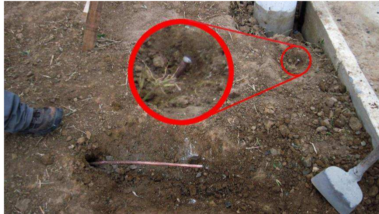
Figura 15 – Fotografia de uma haste de aterramento que entortou e retornou à superfície durante a fixação.
