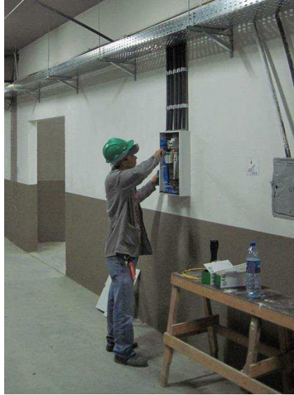
Figura 27 – Fotografia da equipe da Viridis Engenharia realizando a montagem de um dos quadros de distribuição.
