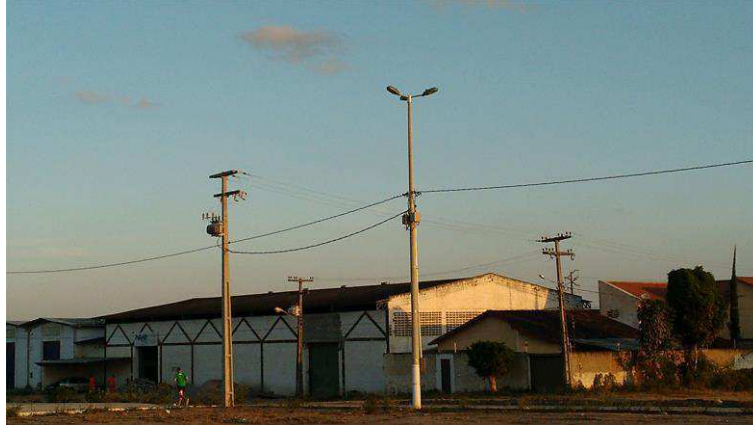
Figura 17 – Fotografia da subestação aérea concluída.
