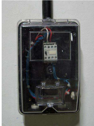
Figura 10 - Fotografia do quadro de comando utilizado para acionar os refletores de 400 W.
