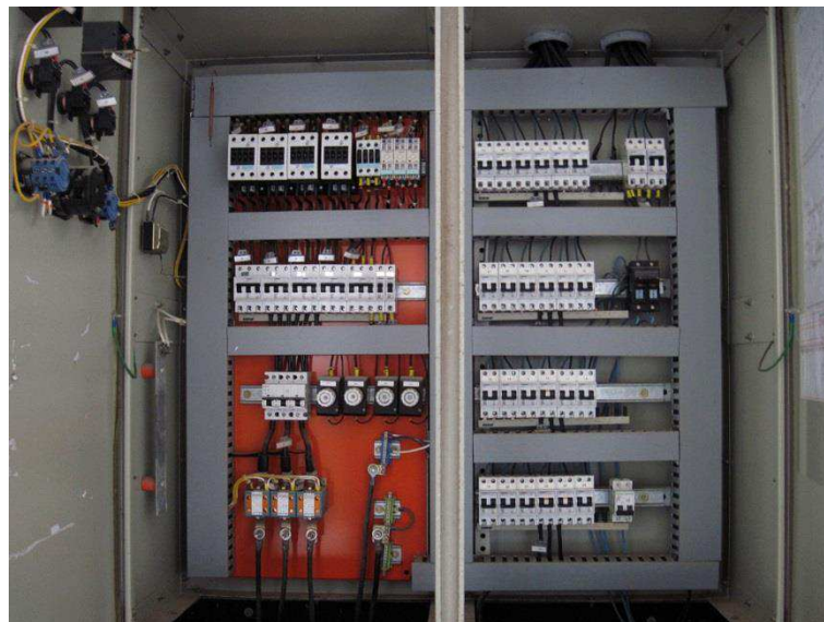
Figura 33 – Parte interna do quadro de comando dos refletores.
