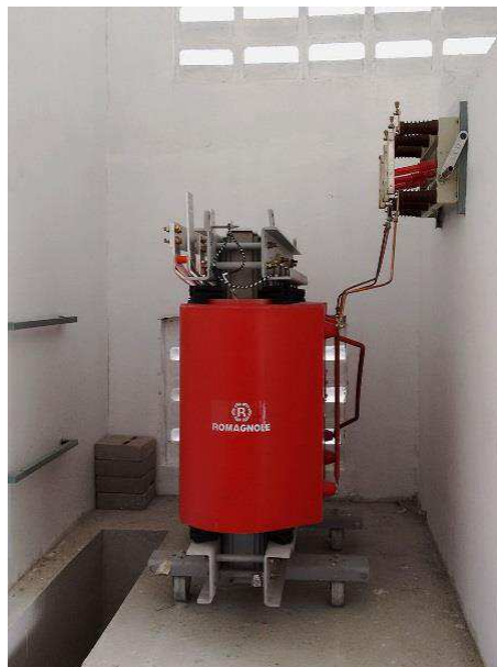
Figura 47 – Fotografia do transformador já conectado à chave seccionadora.
