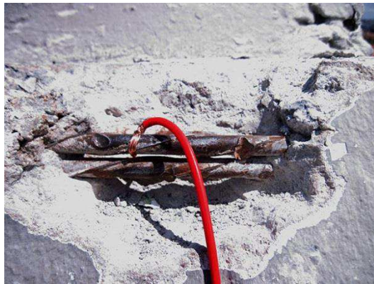
Figura 38 - Fotografia da conexão de medição da resistência de aterramento.
