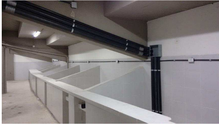
Figura 34 – Fotografia dos eletrodutos para passagem dos cabos de alimentação dos quadros da marquise.
