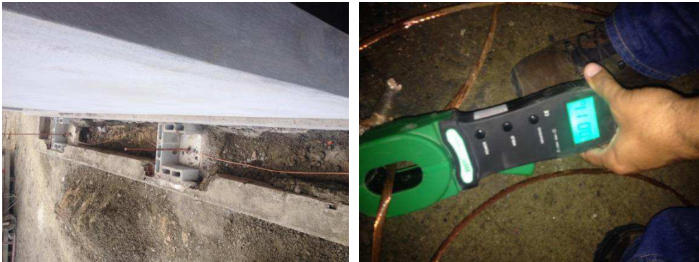
Figura 33 Verificação da resistência da malha de aterramento.
