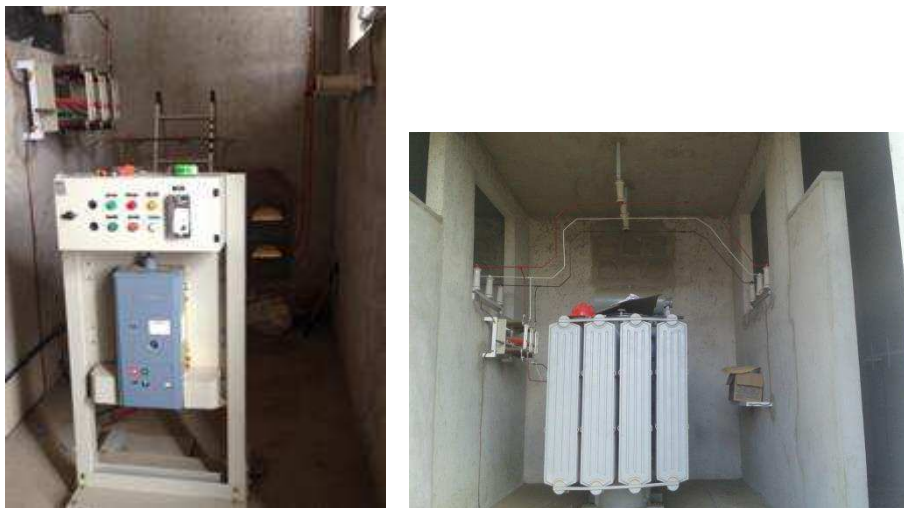
Figura 34 Cubículos de disjunção e transformação.
