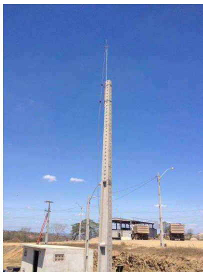
Figura 35 Poste com SPDA.
