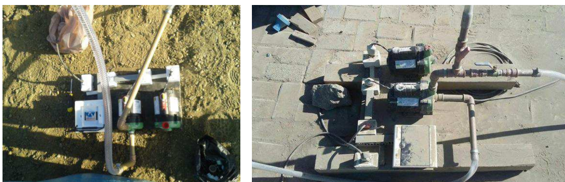
Figura 15 Bombas do sistema de pulverização: à esquerda imagem do primeiro dia de instalação; à direita imagem após seis meses de uso.
