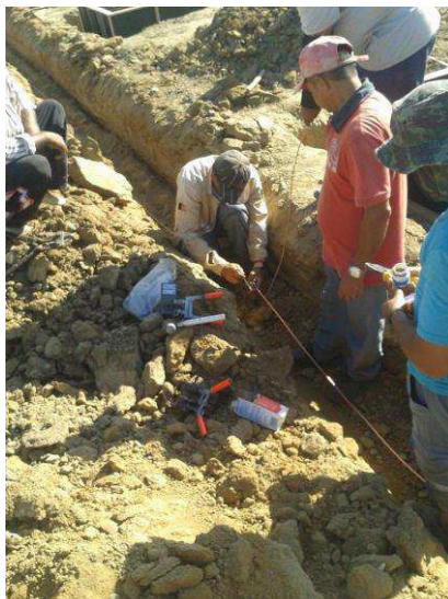
Figura 39 Malha de aterramento das balanças.
