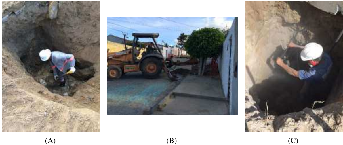
Figura 4.3: Escavações para estruturas: (A) manual; (B) retroescavadeira com rompedor; (C) compressor de ar com rompedor.
