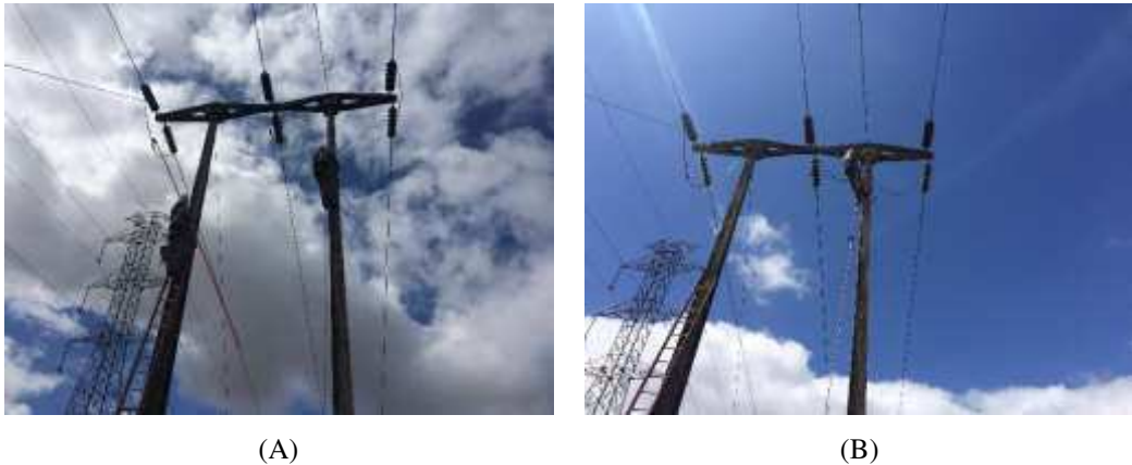
Figura 4.18: Procedimentos de segurança em linhas desenergizadas: (A) teste de ausência de tensão; (B) conexão do conjunto de aterramento aos cabos condutores.
