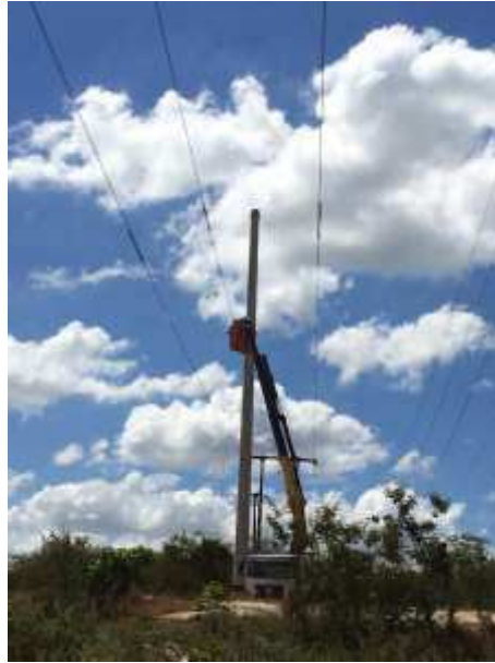
Figura 4.19: Poste implantado abaixo da linha desenergizada.
