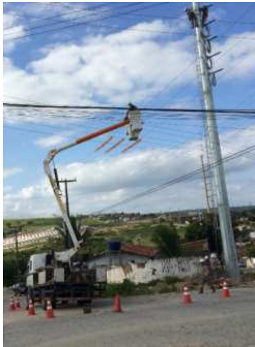
Figura 2.12: Área sinalizada com cones de sinalização, correntes zebradas de sinalização e faixas de sinalização.
