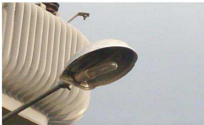
Figura 9: Luminária inadequada para utilização em iluminação pública.
