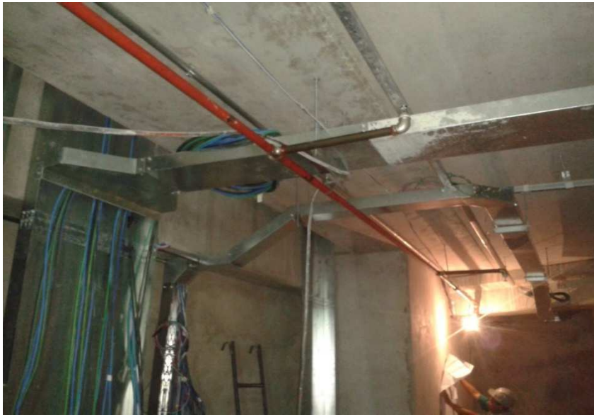
Figura 10–Shaft de instalações elétricas.
