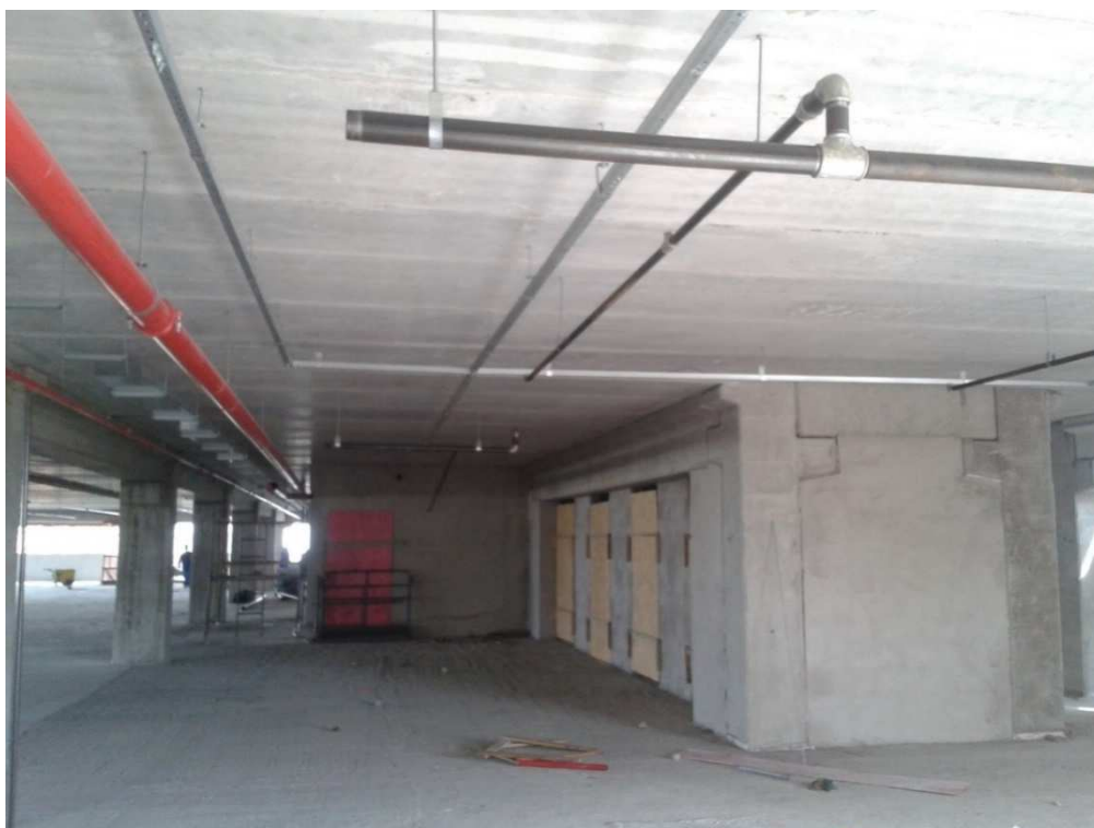
Figura 13–Rede de hidrantes e rede de sprinkler .
