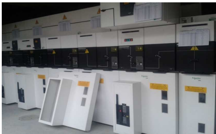
Figura 5–Cubículos de medição de média tensão.
