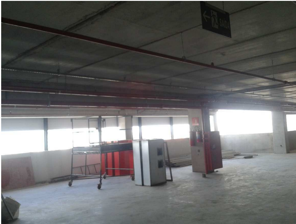
Figura 17–Instalações de combate a incêndio.
