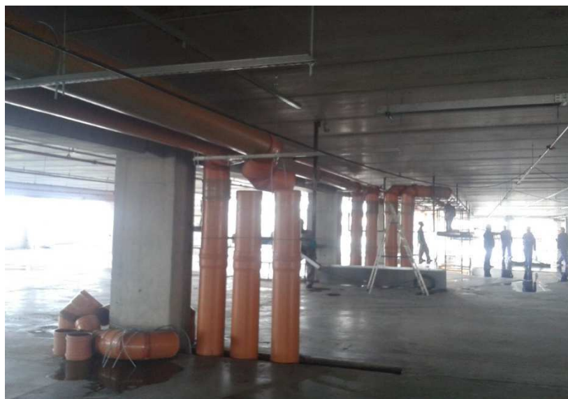
Figura 18–Rede de captação de águas pluviais.
