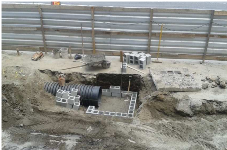
Figura 19—caixa de areia e rede de drenagem das águas pluviais.
