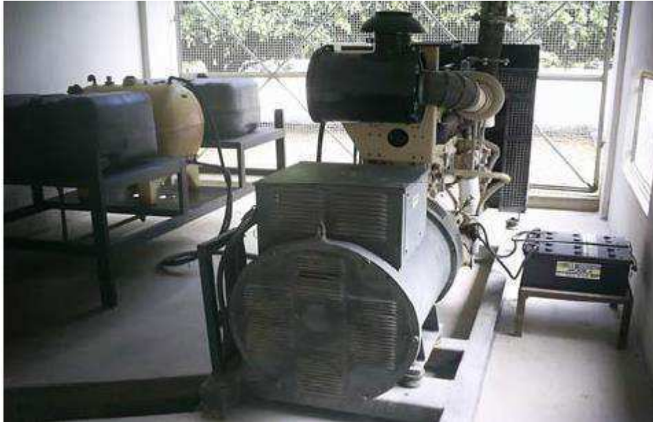
Figura 22. Gerador de 450 kVA.
