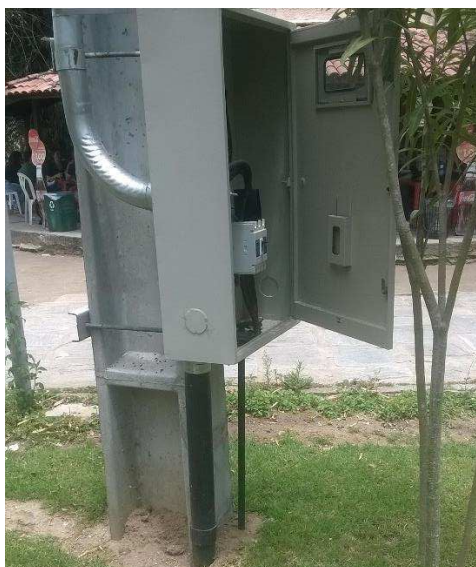
Figura 20. Quadro transformador próximo à biblioteca.
