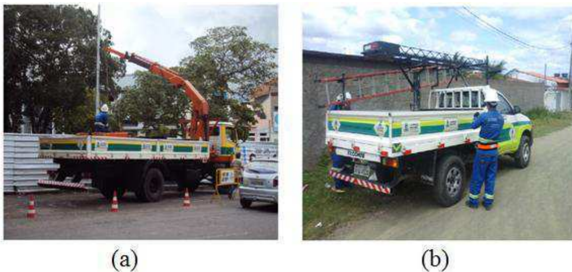
Figura 3.21 – (a) Retirada de um poste da praça da bandeira; (b) Preparação para manutenção de um poste no distrito de Galante - exemplo dos EPI e EPC.
