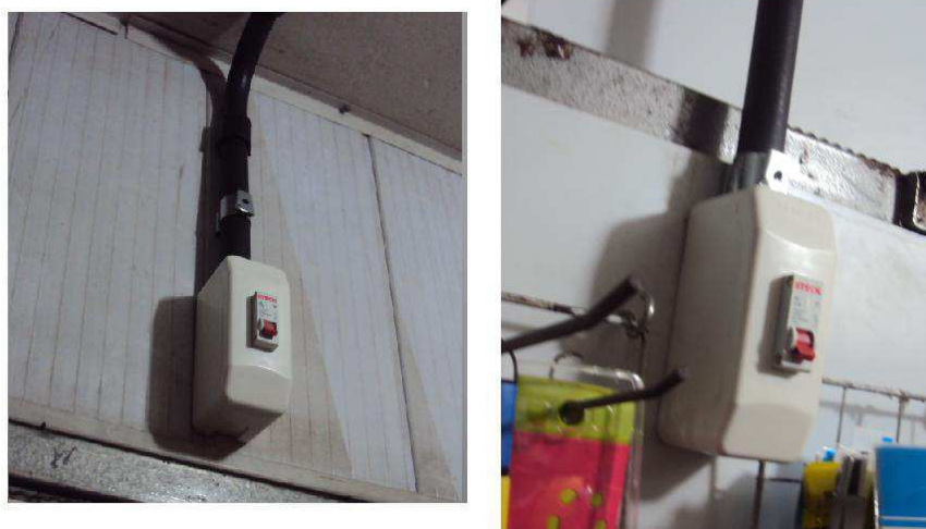
Figura 3.1 - Disjuntores instalados nas lojas
