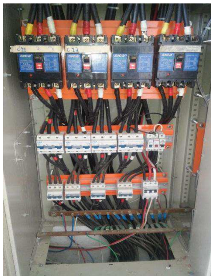
Figura 2 - Quadro de distribuição
