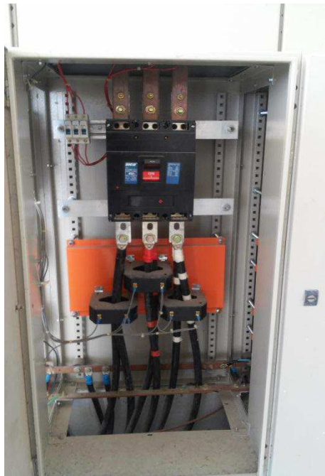
Figura 1 – QGBT do central de Aula
