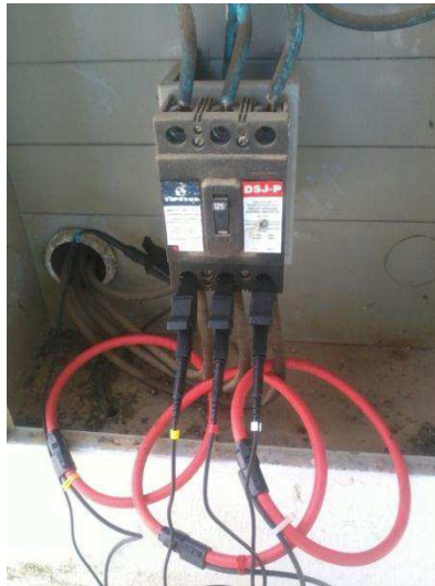
Figura 6 – Instalação do Analisador de Energia na saída do medidor
