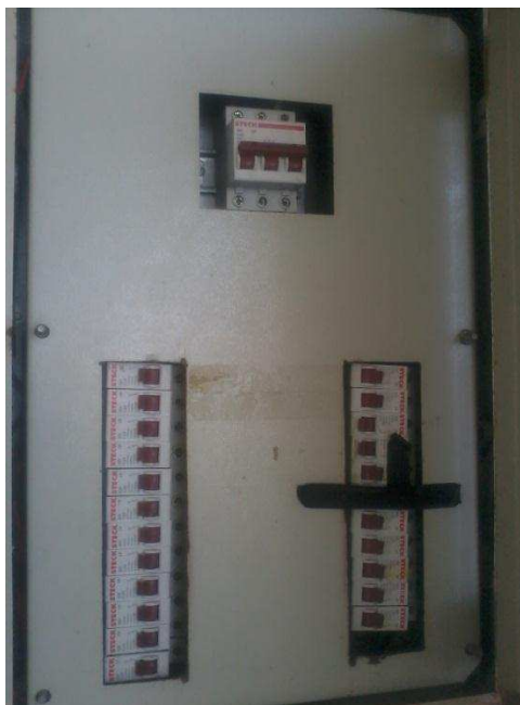
Figura 9 – Quadro de distribuição
