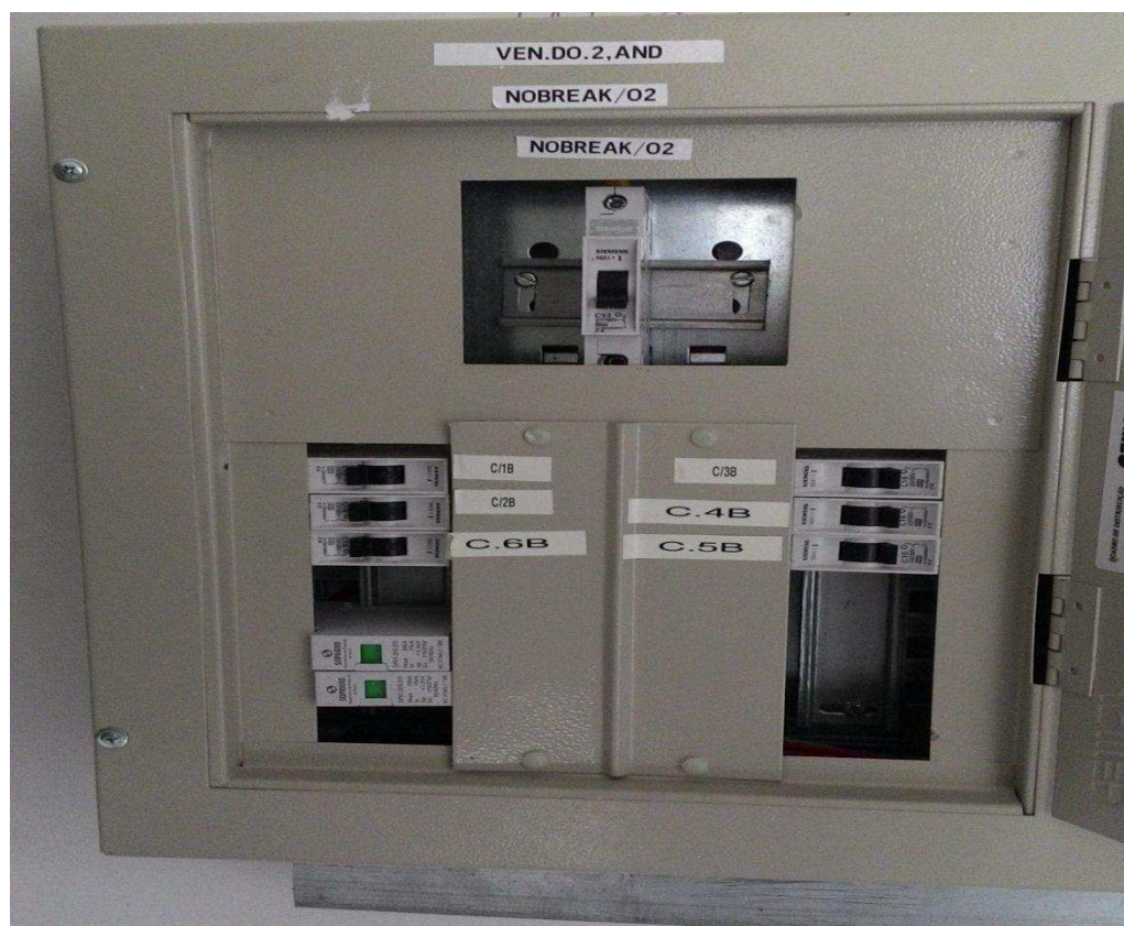
FIGURA 13. QUADRO DE DISTRIBUIÇÃO FINALIZADO
