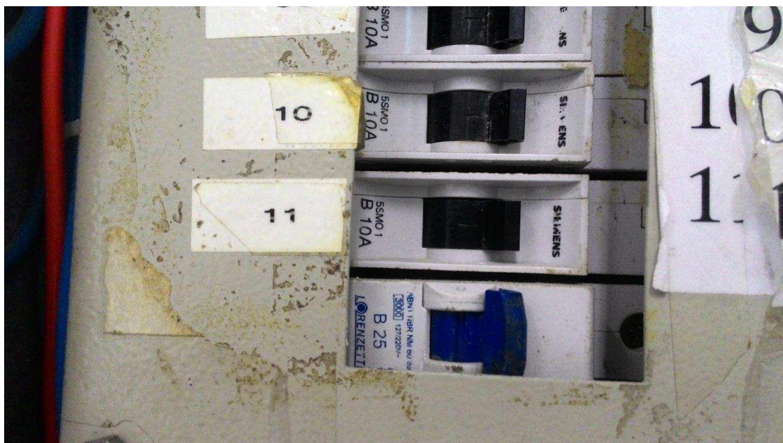
FIGURA 19. DISJUNTOR NÚMERO 11 COM DEFEITO
