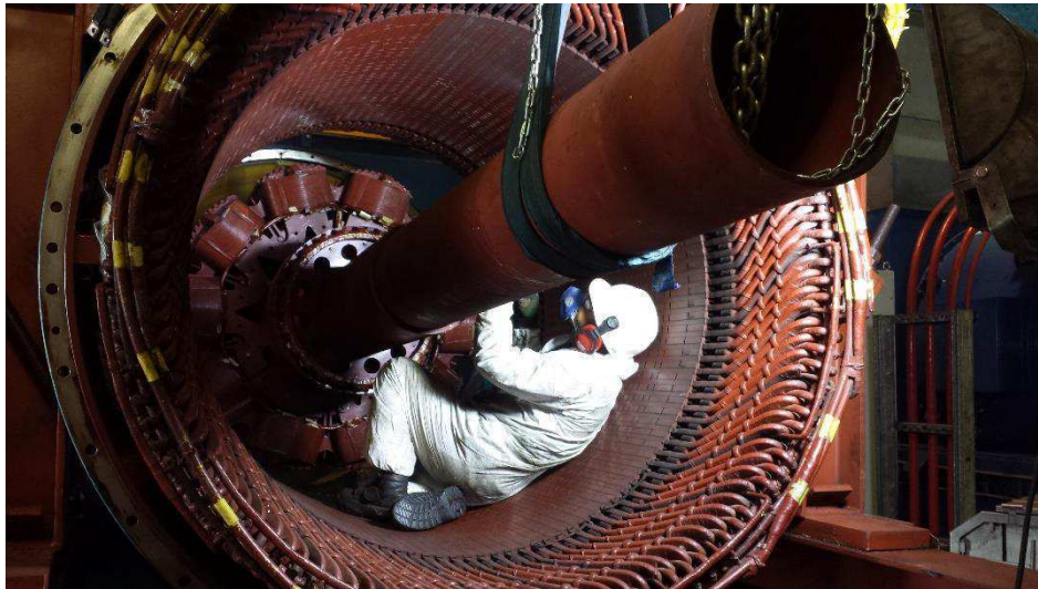
Figura 15 - Colaborador realizando a limpeza interna do gerador.
