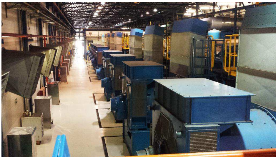
Figura 6 - Casa de máquinas.
