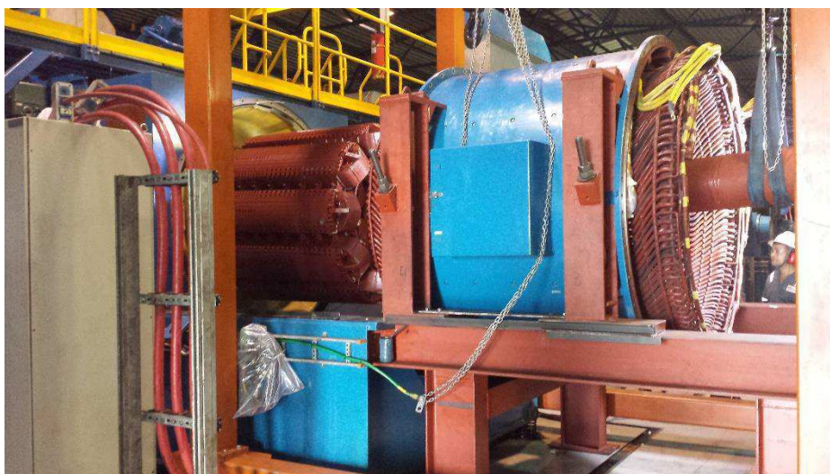
Figura 14 - Gerador AVK com estator sacado.
