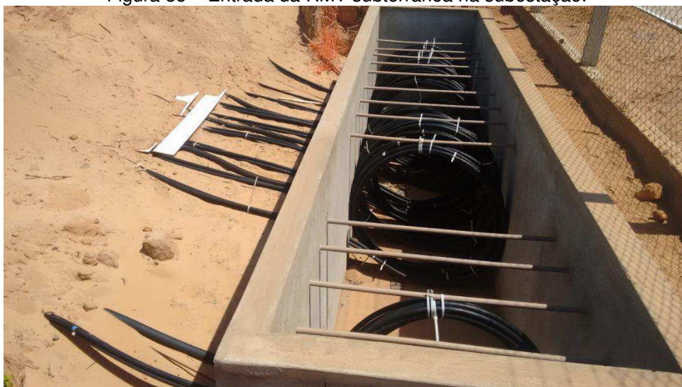
Figura 35 – Entrada da RMT subterrânea na subestação.
