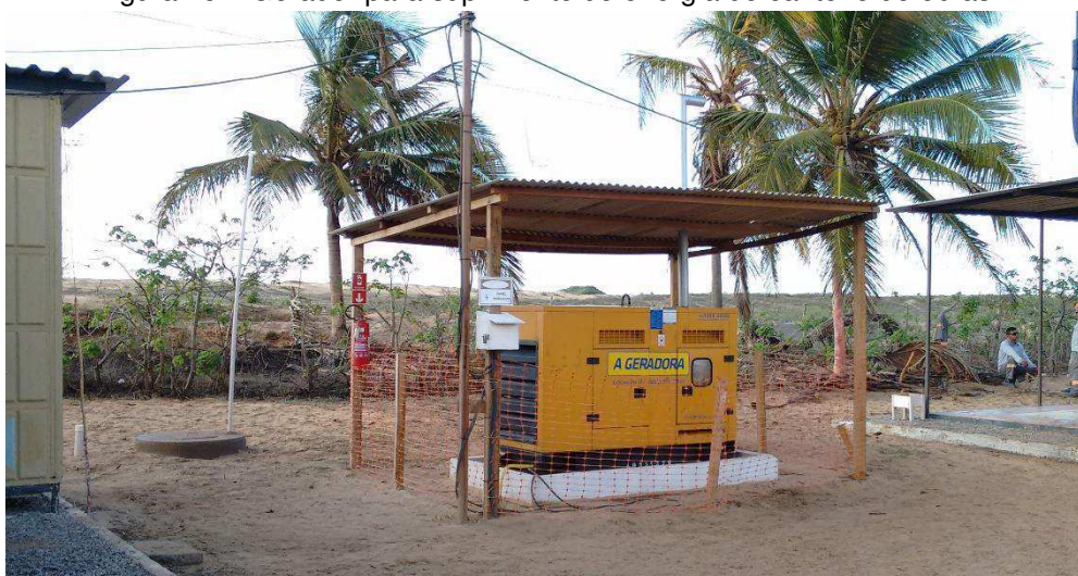
Figura 45 – Gerador para suprimento de energia do canteiro de obras.
