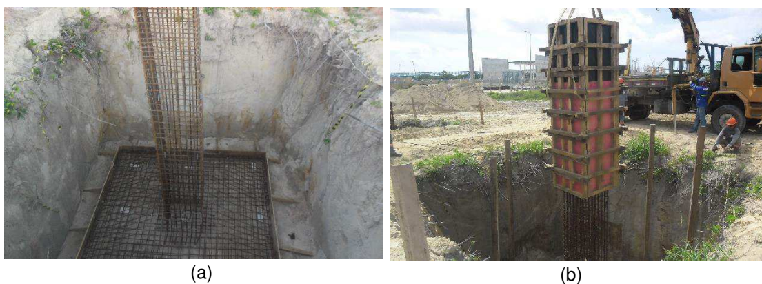
Figura 14 – Etapas da execução de fundação em concreto armado para torre de aço.
