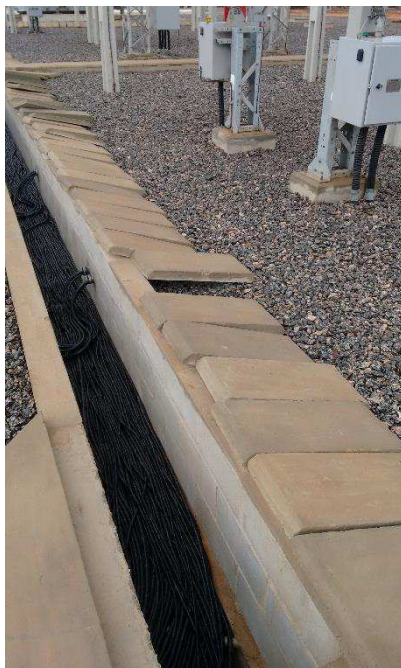
Figura 34 – Cabos de comando da SE expostos.
