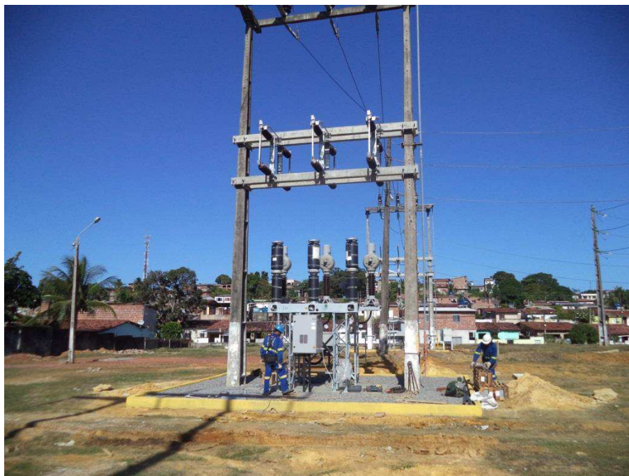
Figura 2.1 – Montagem de BAY na SE Pau Amarelo.
