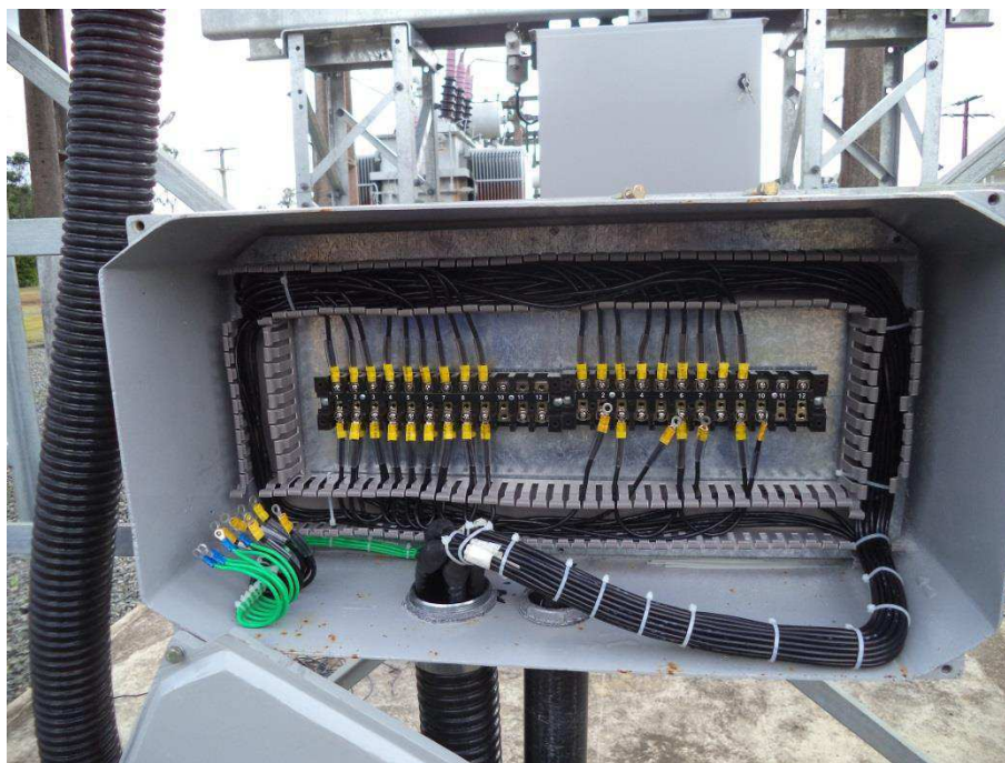
Figura 2.2 – Conectorização BAY da SE Botafogo.
