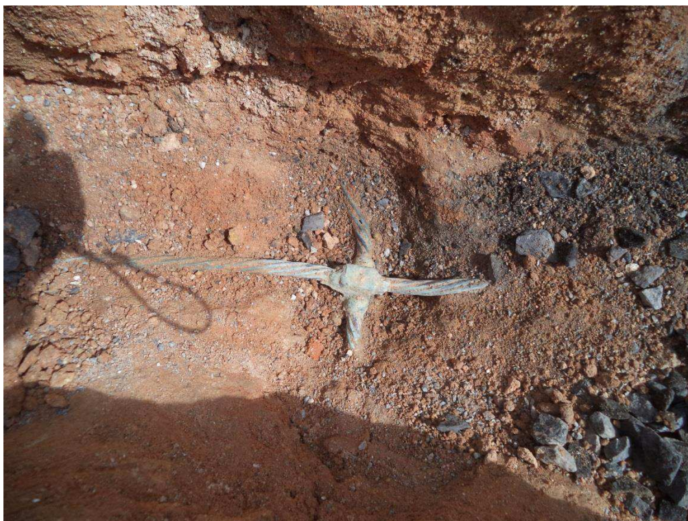
Figura 2.12 – Identificação de solda exotérmica na malha de aterramento.
