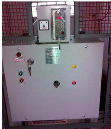
Figura 11 - Relé de sobrecorrente e Disjuntor
