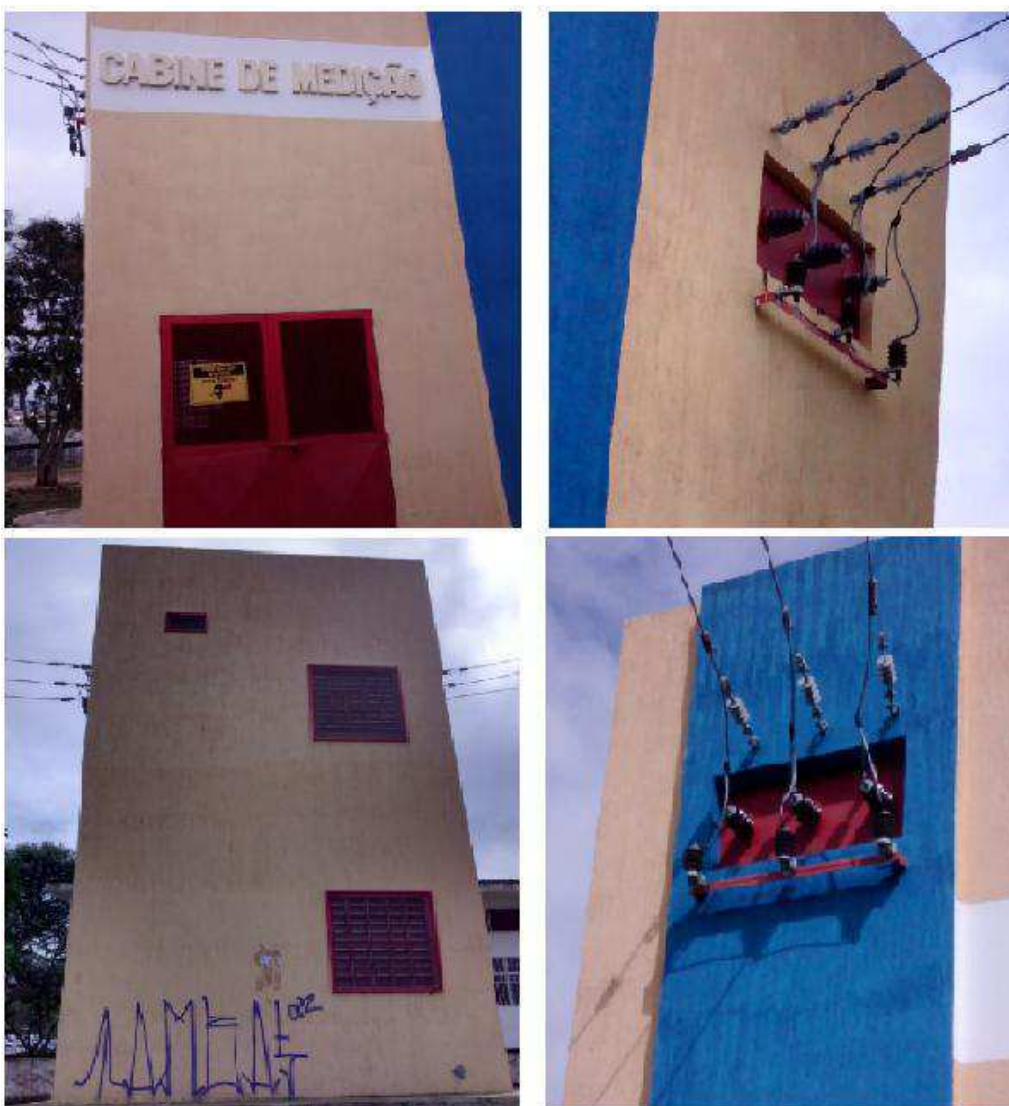
Figura 9 - Cabine de Medição
