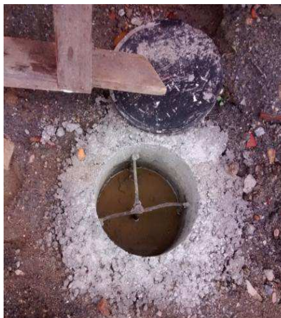
Figura 5 - Detalhe de aterramento
