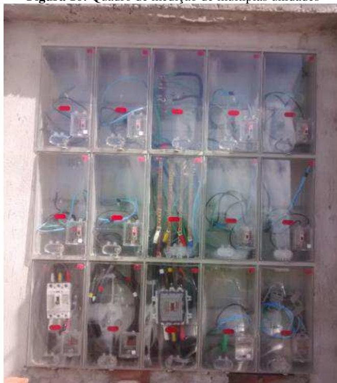
Figura 16: Quadro de medição de múltiplas unidades
