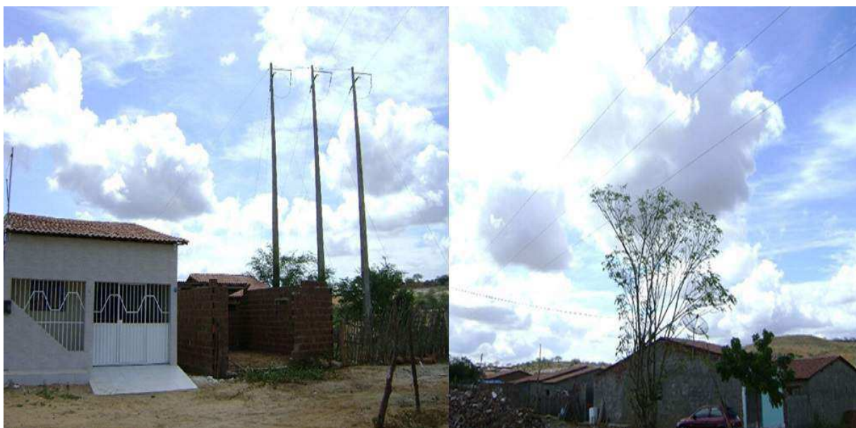
Figura 27 – Casas na faixa de servidão da LT de 69 KV.
