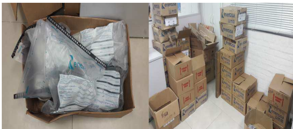
Figura 15 – Jamper, Desvio no Ramal de Entrada Embutido, Neutro Isolado, Sacola Plástica com o Medidor.
