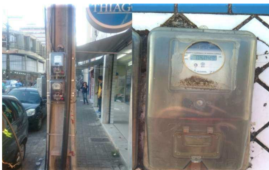
Figura 8 – Medidores com problemas de Leitura.
