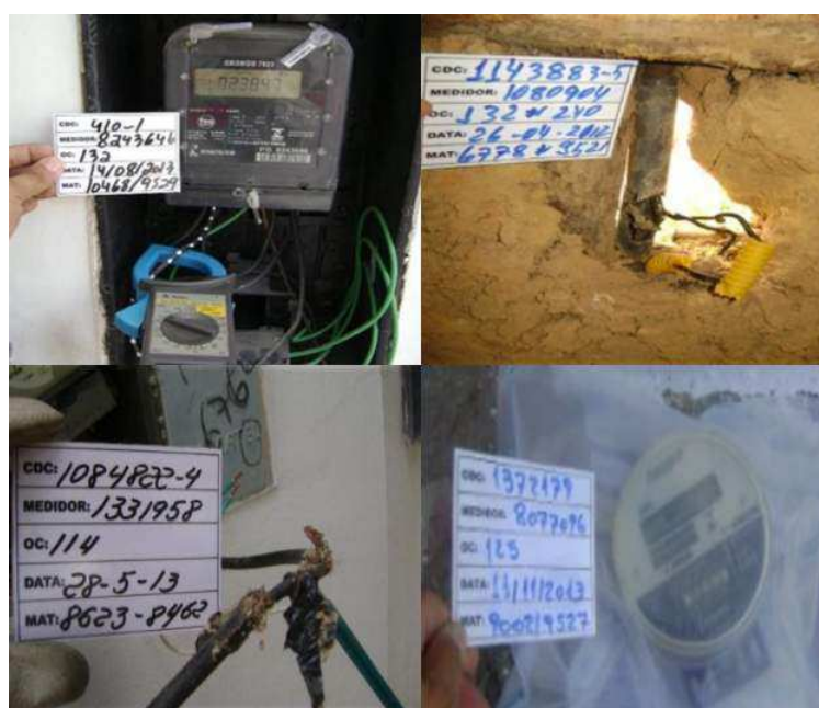
Figura 14 – Jamper, Desvio no Ramal de Entrada Embutido, Neutro Isolado, Sacola Plástica com o Medidor.
