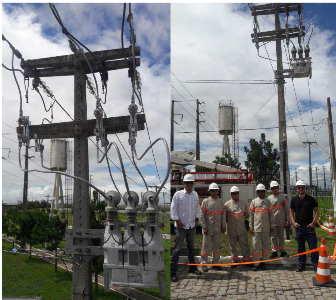
Figura 35 – Instalação do Projeto do Sistema de Bypass para o Equipamento Serta.
