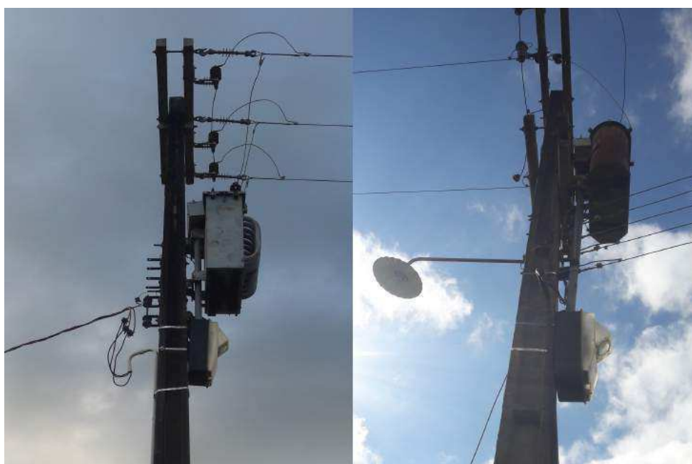
Figura 10 – Blindagem de Transformador.
