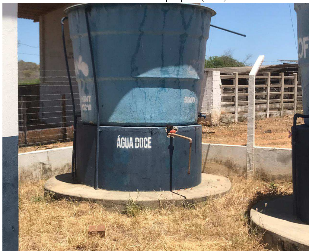
IMAGEM 20: Reservatórios de água doce.
