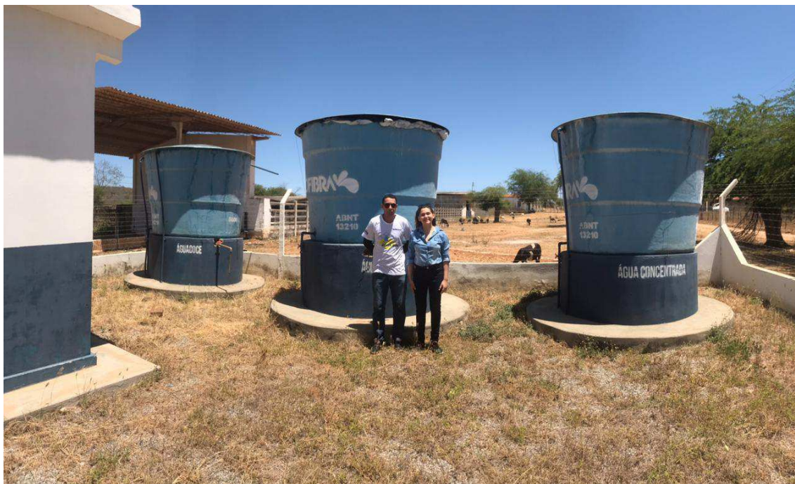
IMAGEM 21: Reservatórios de água doce, água bruta e concentrado. FONTE: Dados da pesquisa (2019).
