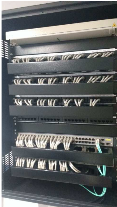
Figura 20 – Detalhe do Rack-02A
