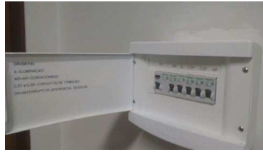
Figura 10 – Identificação dos quadros monofásicos
