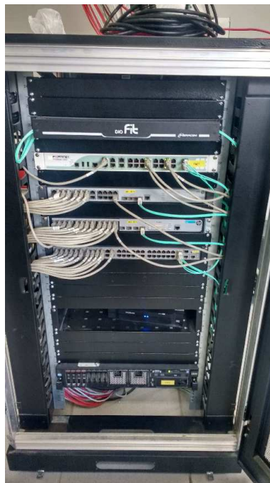
Figura 18 – Detalhe do Rack-01A
