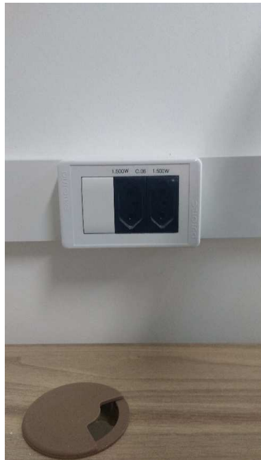
Figura 16 – Detalhe da identificação das tomadas
