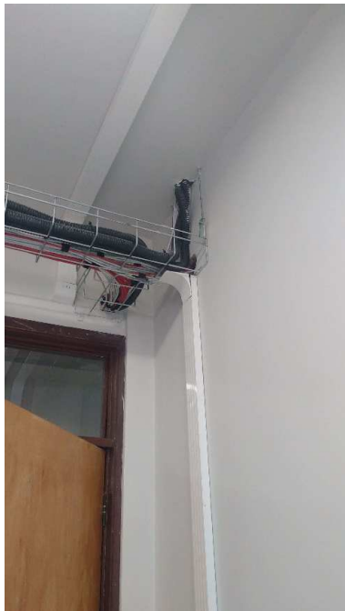
Figura 25 – Detalhe da descida dos cabos para a eletrocalha aramada vindo do 1º Andar
