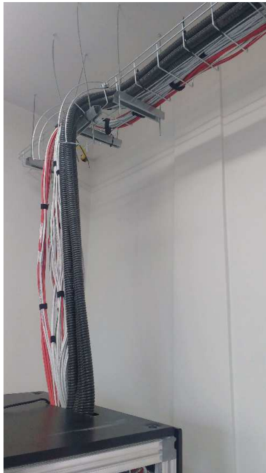
Figura 24 – Detalhe da descida dos cabos para o Rack-01A
