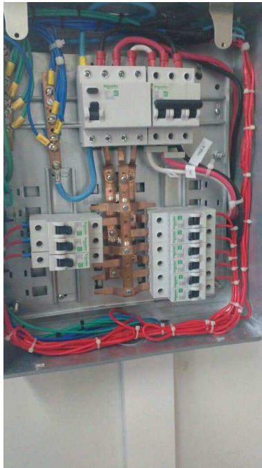
Figura 8 – Quadro trifásico da sala 03
