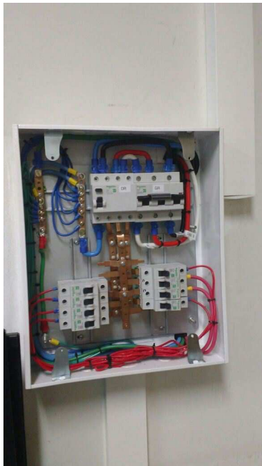
Figura 9 – Quadro trifásico da sala 02 após identificação
