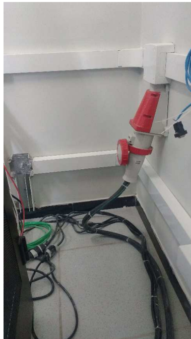
Figura 12 – Plug trifásico localizado na sala do Suporte
