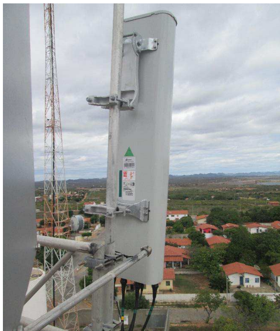
Figura 18 - Antena APXVBLL15X-I20 instalada no site NLJN00, Jaguaribara/CE (Fonte: SAVENGE Engenharia LTDA)
