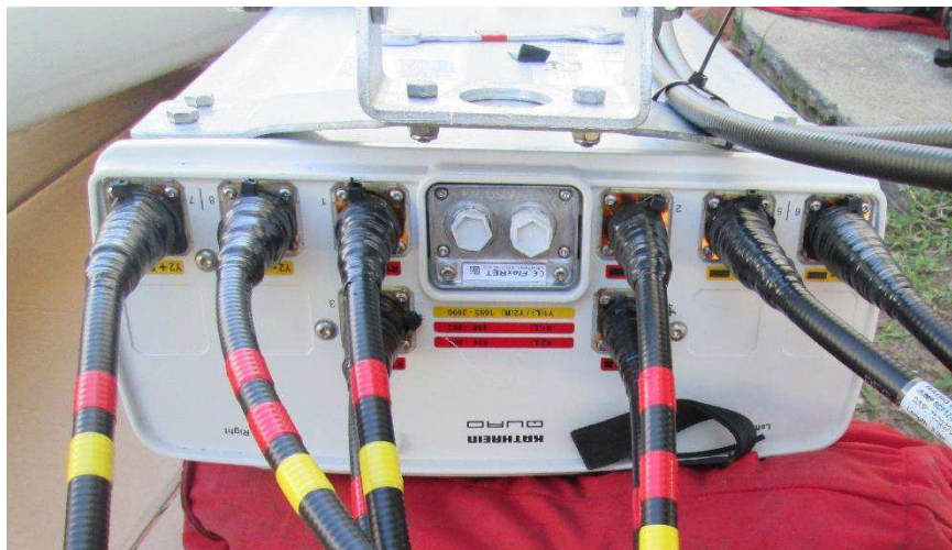
Figura 15 - Antena Kathrein 80010767 (Fonte: SAVENGE Engenharia LTDA)
