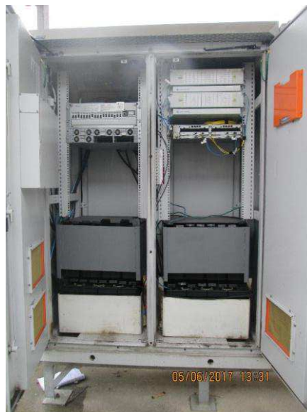
Figura 9 - Gabinete OPSS aberto para mostrar o sistema de energia CC: régua de disjuntores, unidades retificadoras e baterias (Fonte: SAVENGE Engenharia LTDA)
