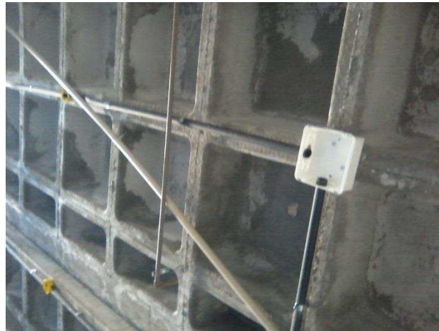
Figura 3 – Detalhe da eletrodutos e caixas de passagem.
