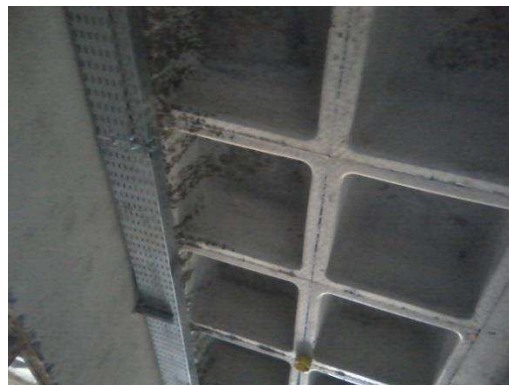
Figura 2 – Detalhe da alocação de eletrocalhas.
