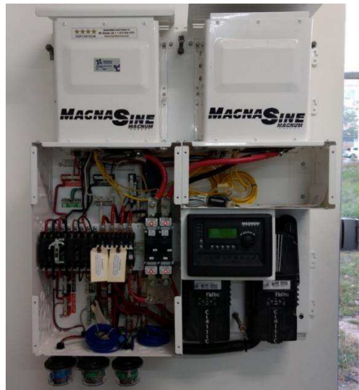
Figura A8 - Painel instalado no LABFREN.
