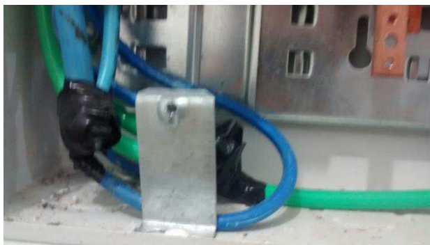
Figura 6: Emenda dos condutores neutro e terra.
