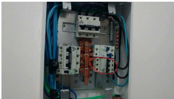
Figura 5: Quadro de distribuição do segundo pavimento.
