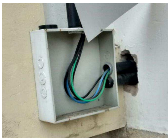
Figura 13: Caixa de passagem externa.
