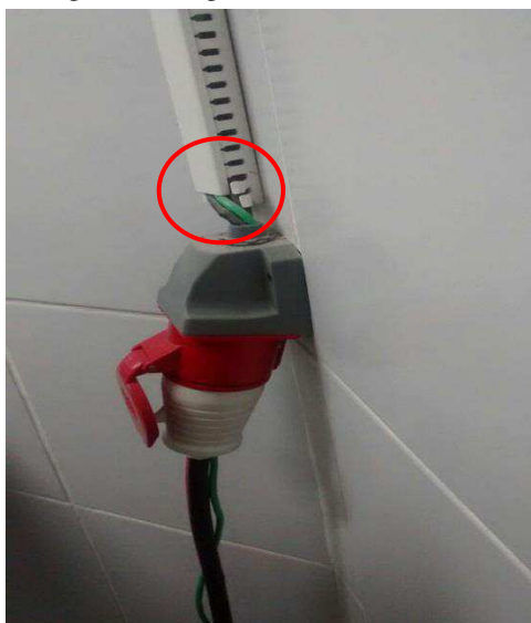
Figura 9: Chegada dos fios no forno 2
