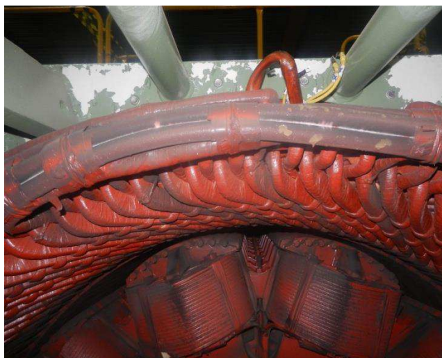
Figura 10 – Pontos de corona no cabeamento do bobinado do estator
