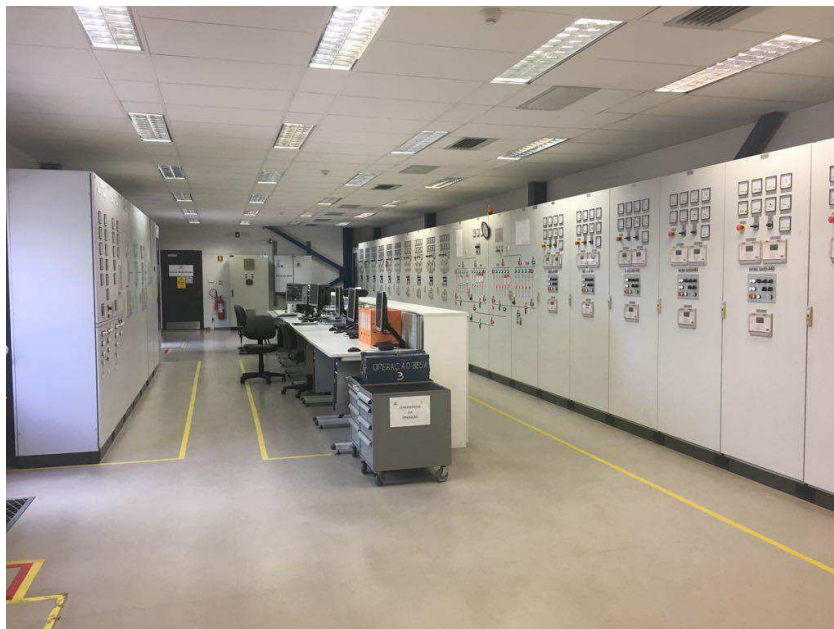
Figura 6 - Sala de controle.
