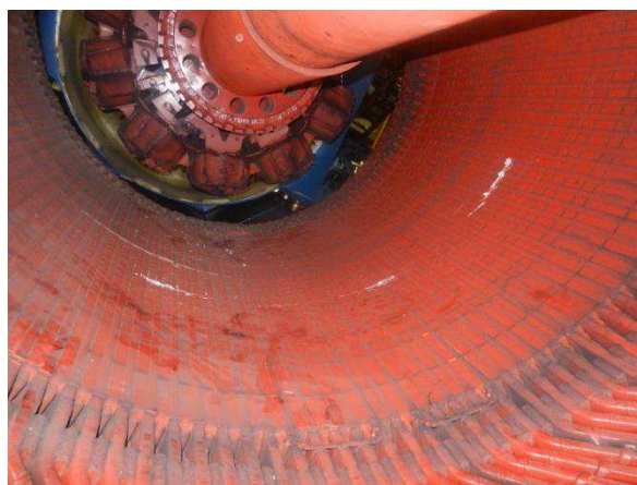
Figura 12 – Acoplamento magnético danificado.
