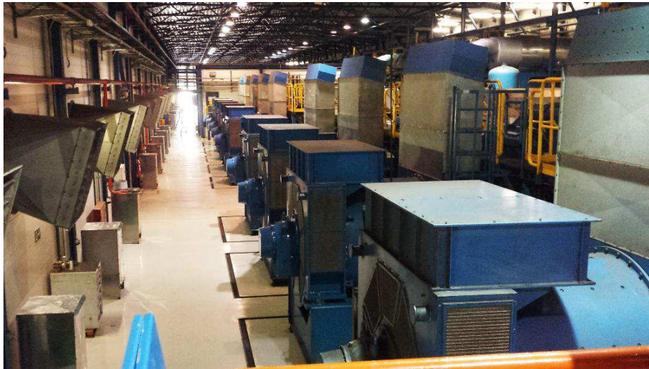
Figura 7 - Sala de máquinas.
