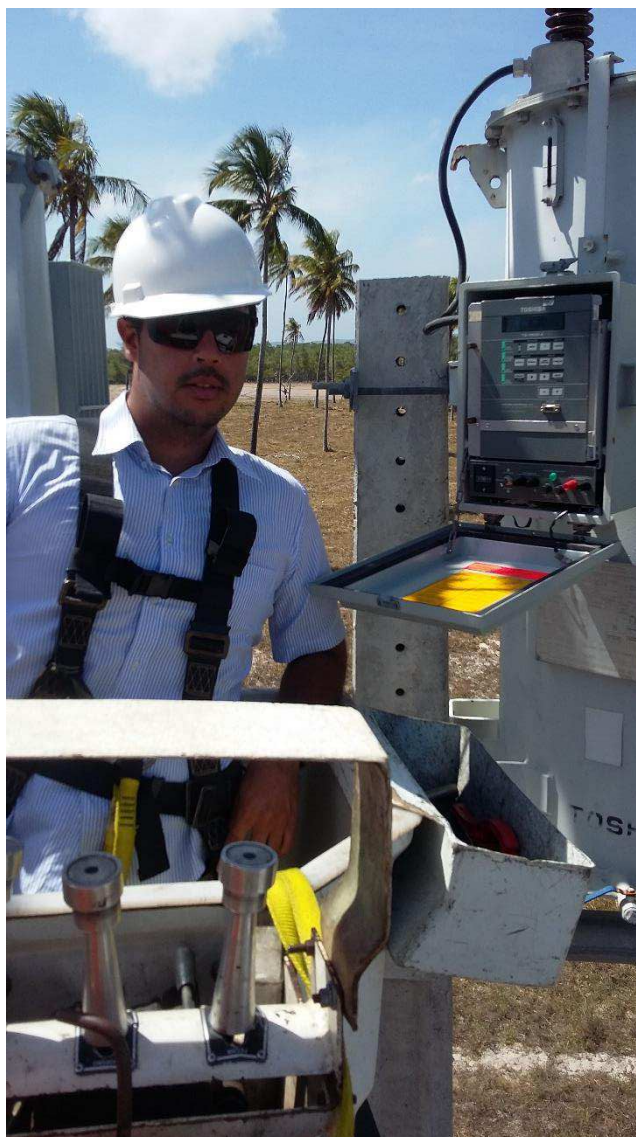
Figura 19: Parametrizando o regulador de Tensão
