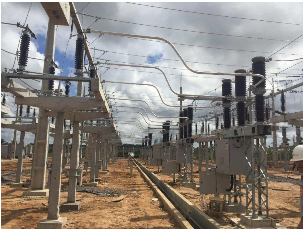
Figura 12: Chave Seccionadora na SE JPL
