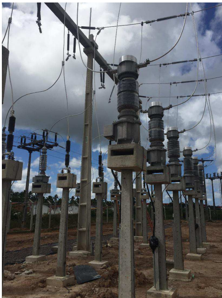
Figura 13: Transformador de Corrente na SE JPL
