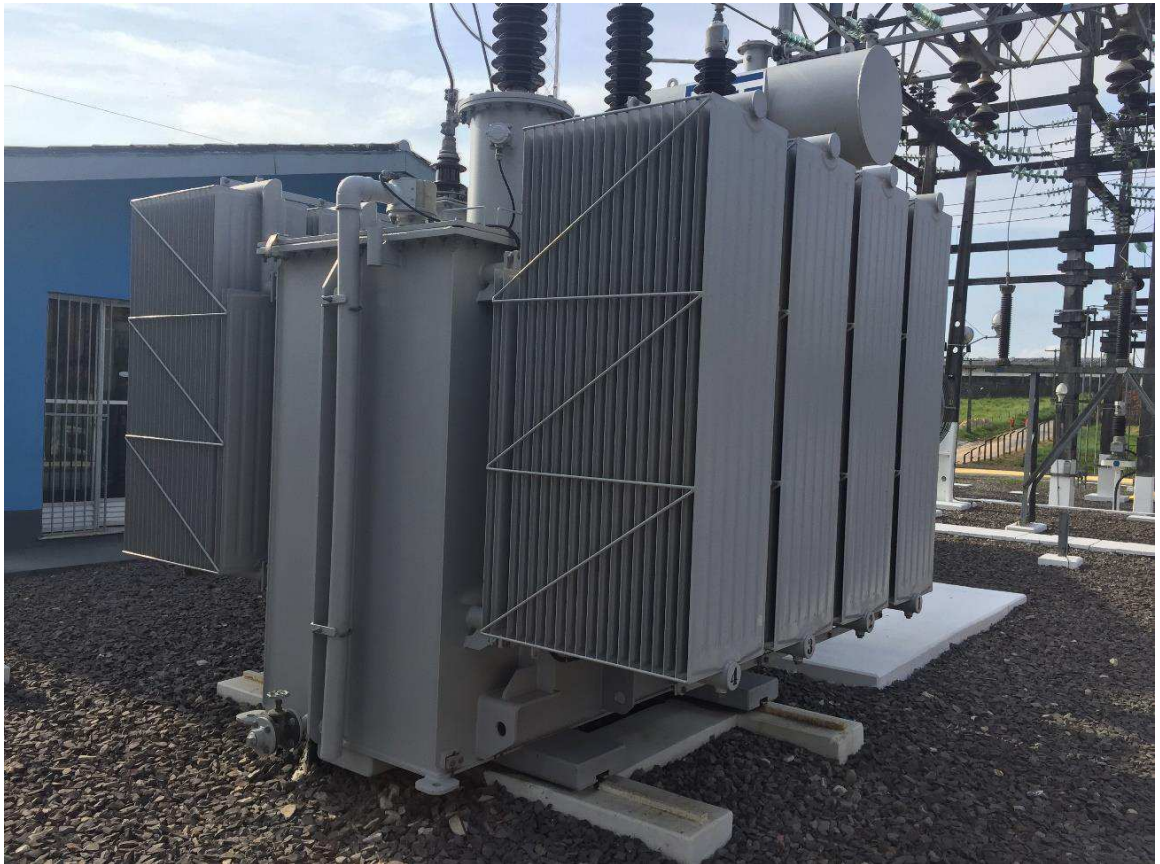
Figura 9: Transformador de 18,75MVA na SE Estância
