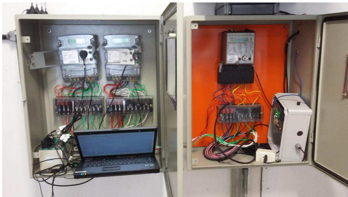
Figura 8: Medidores de Faturamento na subestação da CIT
