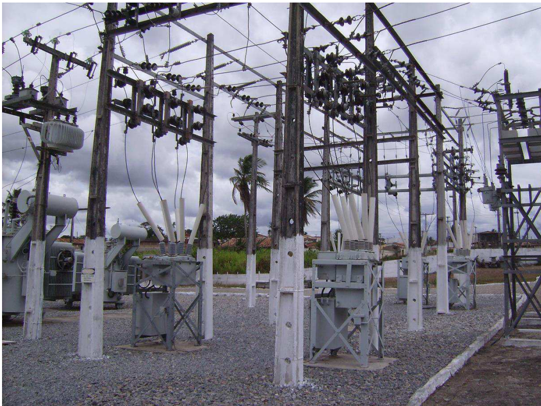
Figura 1: Subestação Itabaianinha, localizada no município de Itabaianinha, em operação desde 1981.
