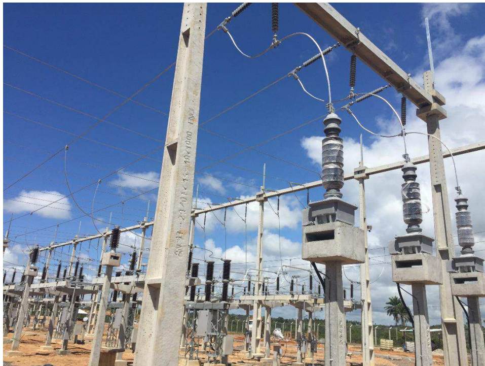
Figura 14: Transformador de Potencial na SE JPL
