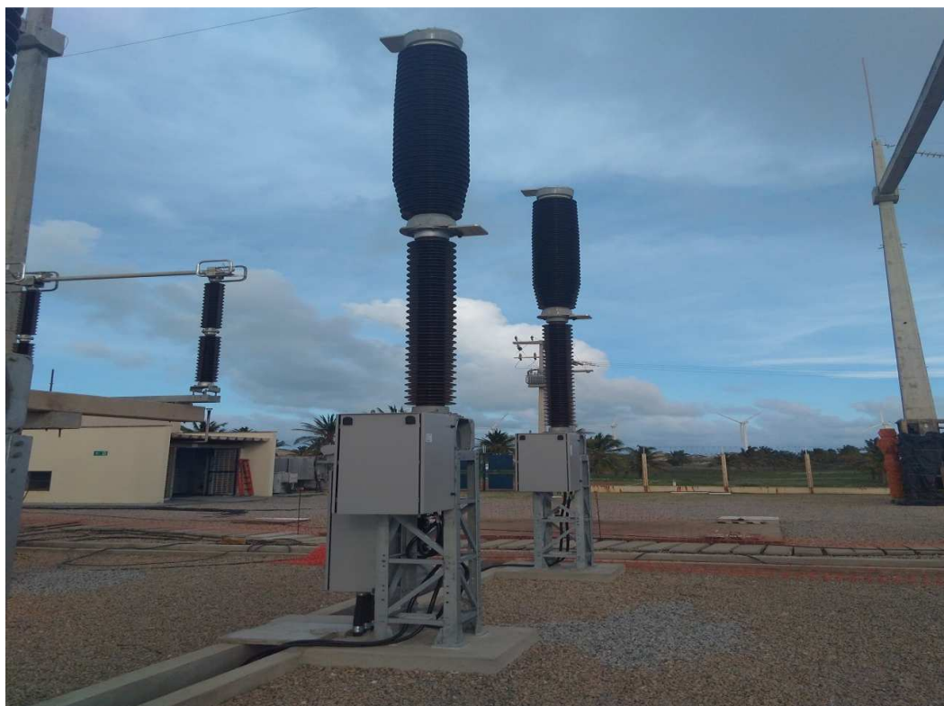
Figura 10- Exemplo de Disjuntor 230 kV
