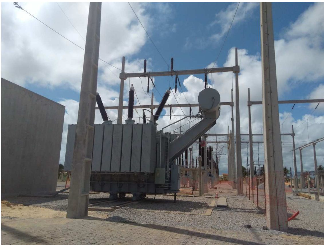
Figura 5- Transformador elevador trifásico 34,5/230 kV
