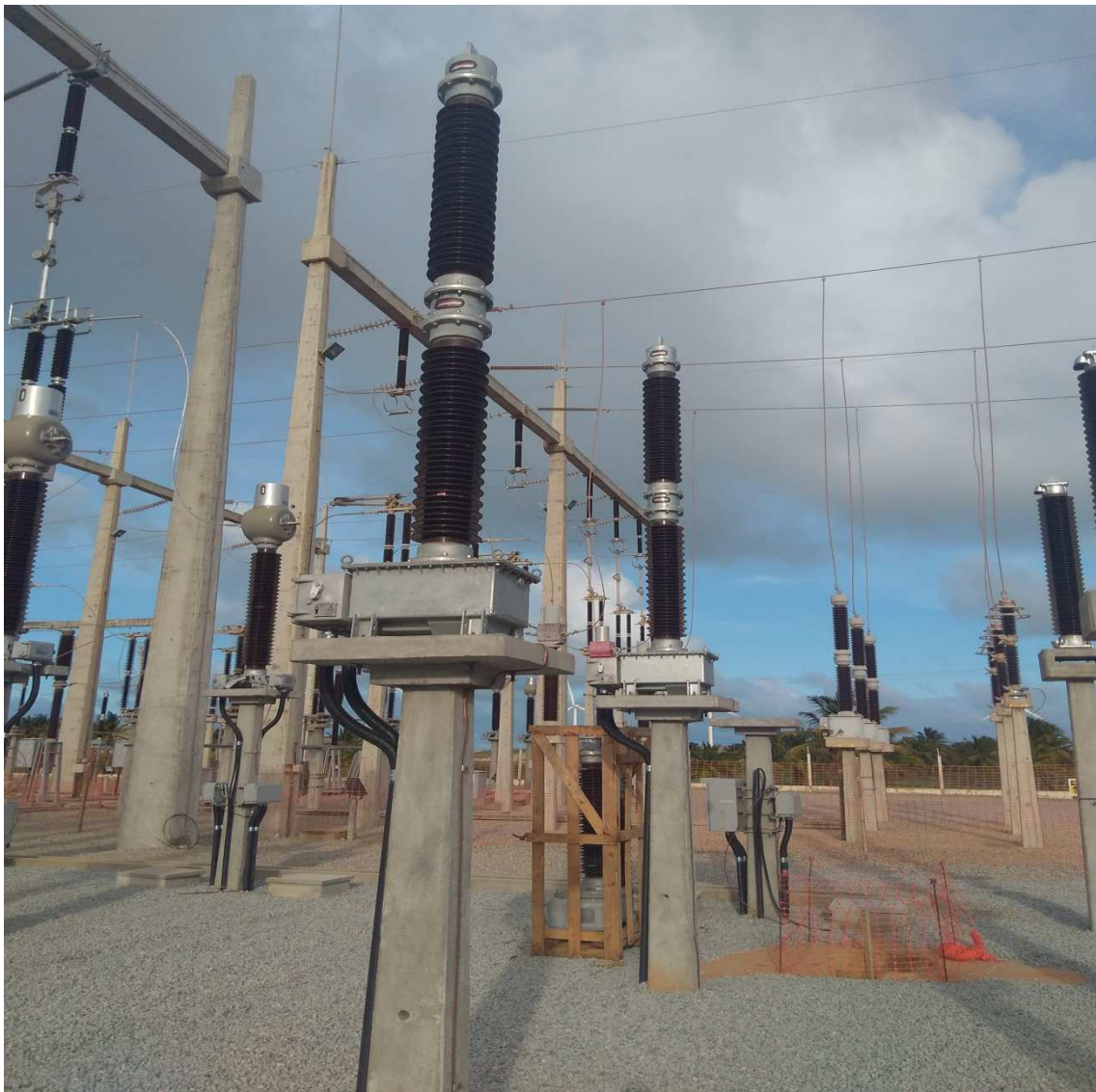
Figura 8-Modelo de Transformador de Potencial Capacitivo 230 kV
