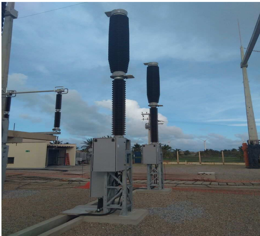
Figura 11- Exemplo de IP 230kV
