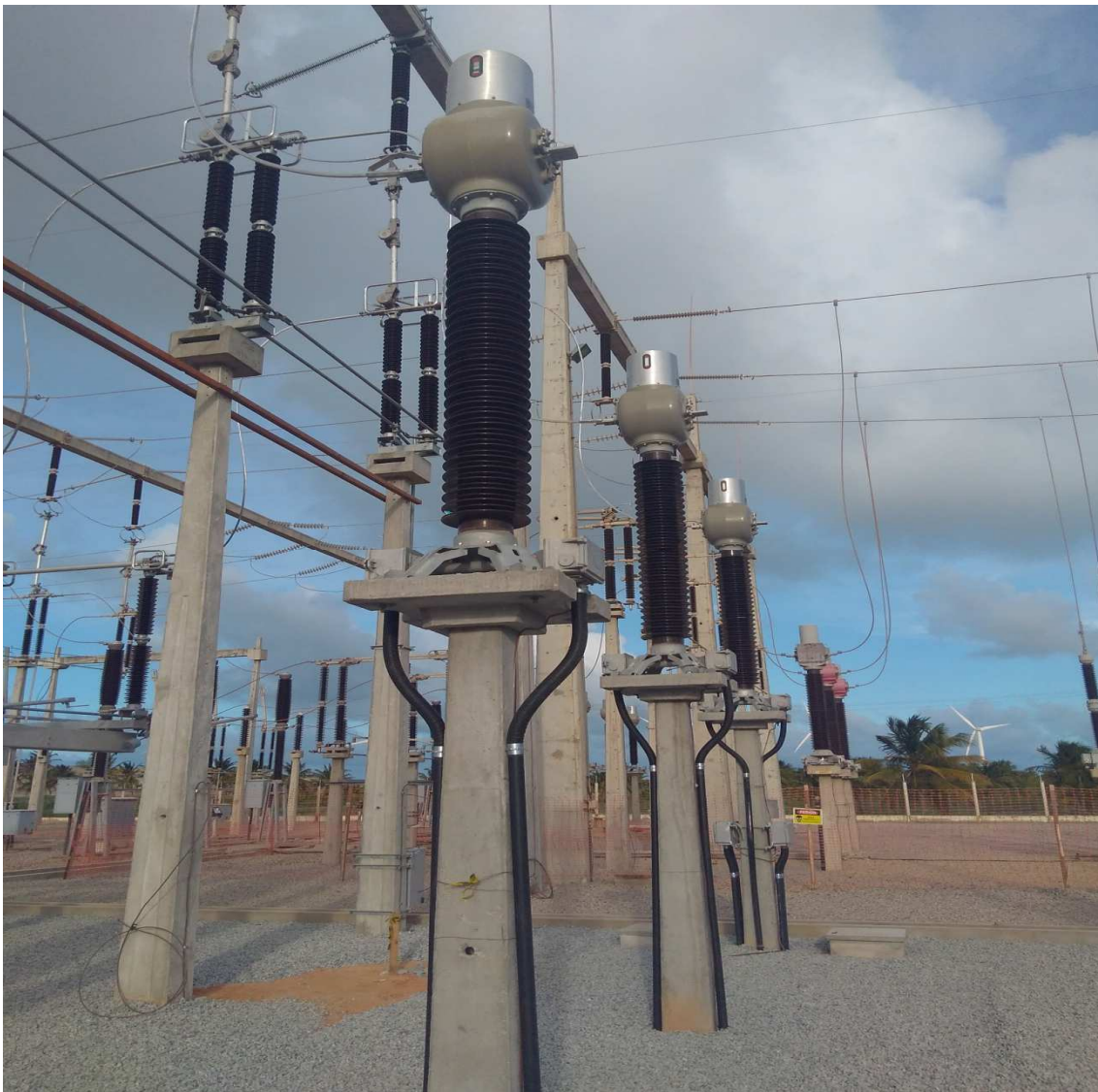
Figura 7- Modelo de Transformador de Corrente 230 kV
