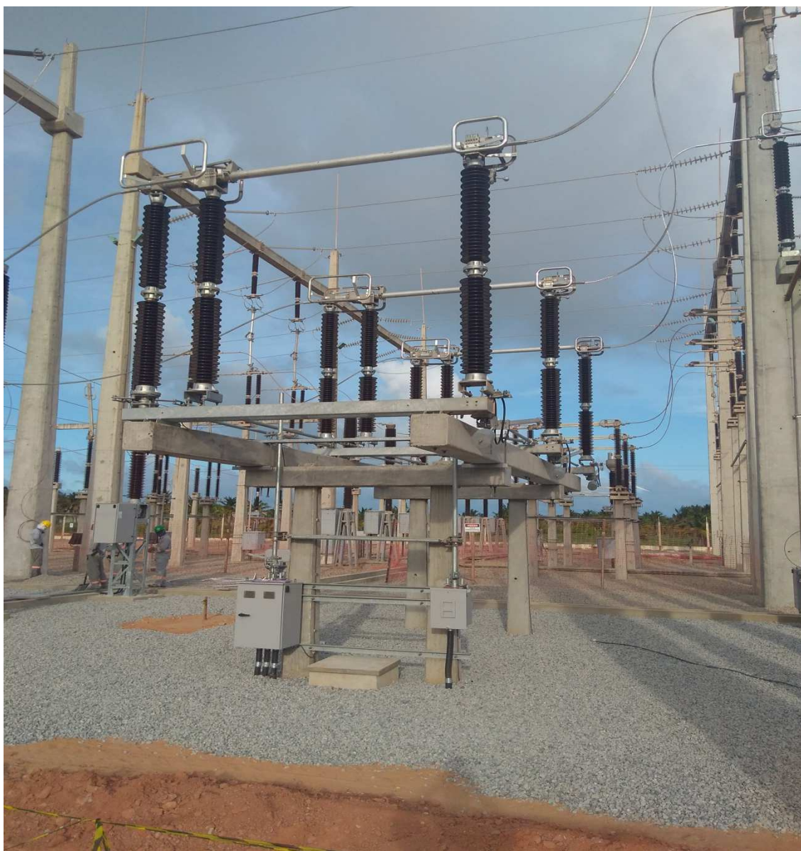
Figura 9 - Exemplo de Chave Seccionadora 230 kV
