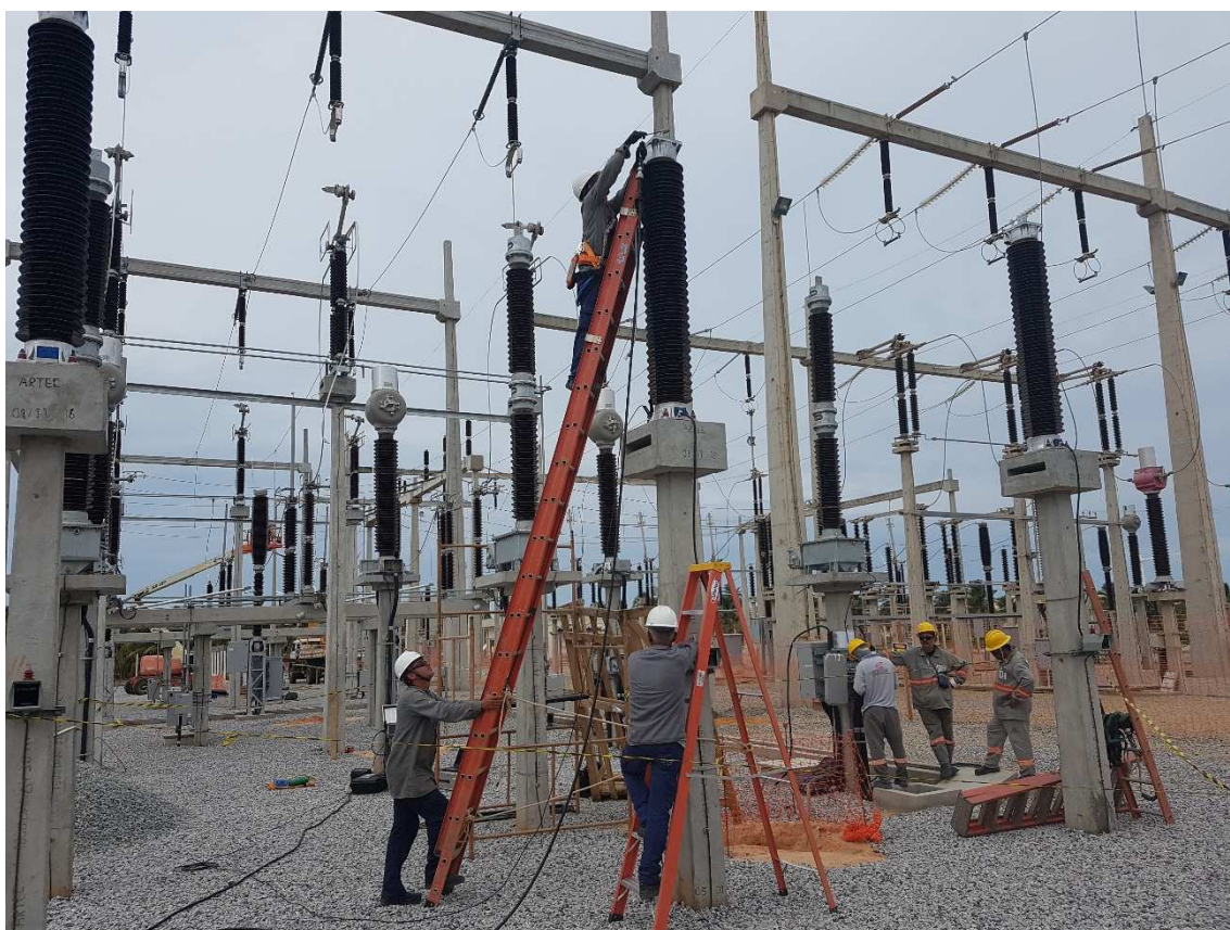
Figura 27: Comissionamento de Equipamento ( Transformador de Potencial)
