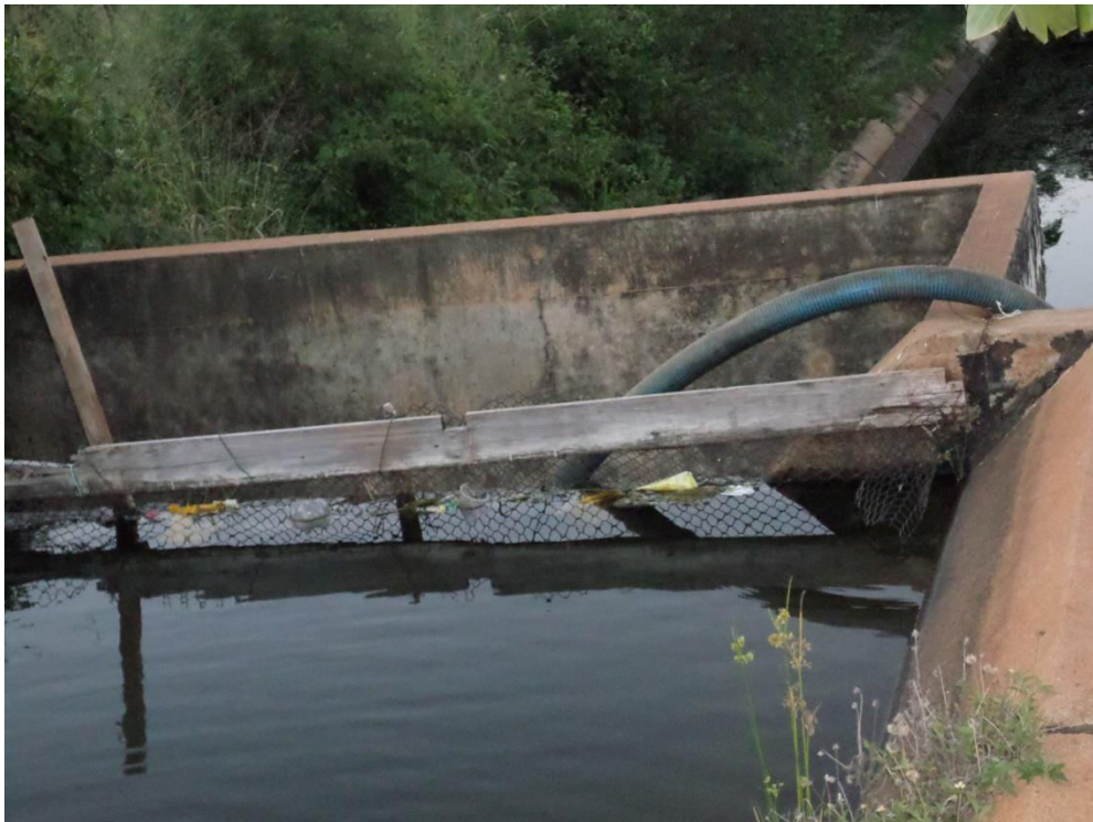
Foto 09 – Captação de água através de Sifão
