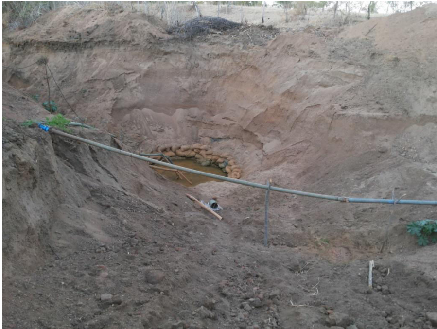
Foto 11 – Barramentos com sacos de areia
