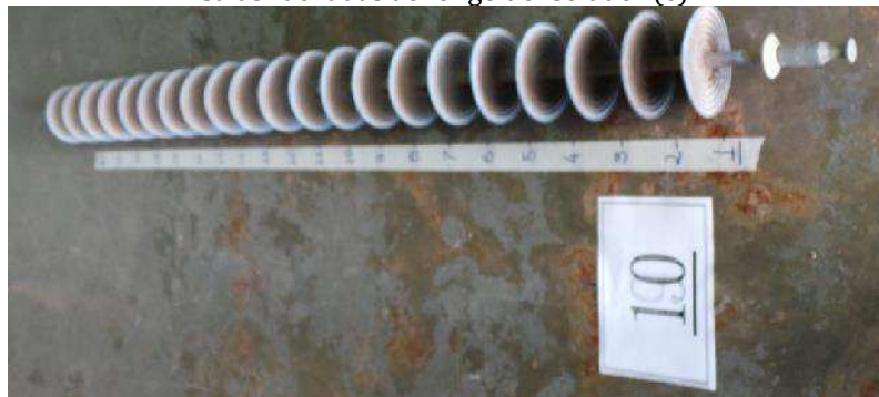
Figura 24: Poluição ao longo do isolador 10 (a). núcleo exposto ao lado do conector de fase (b) e saias rachadas ao longo do isolador (c).
