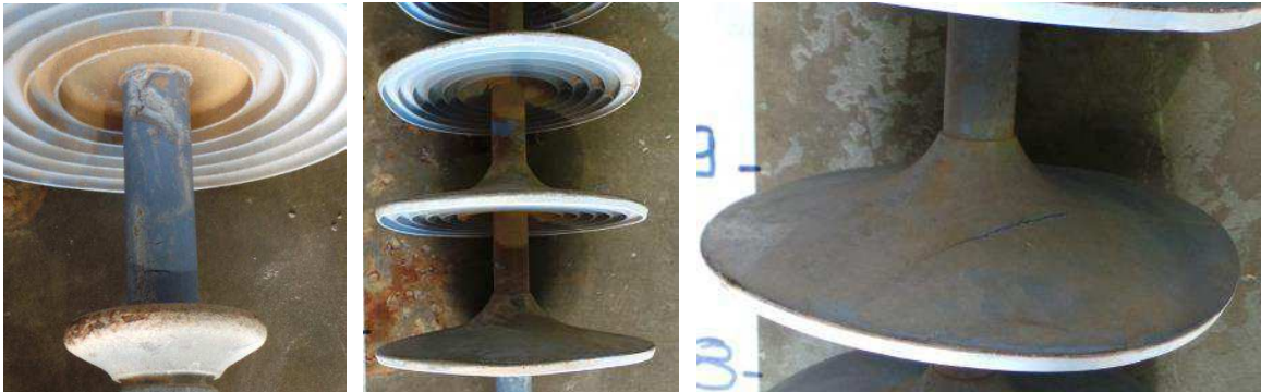
Figura 21: Degradação da superfície protetora (a), poluição (b), e saias danificadas (c) encontradas no isolador 05.
