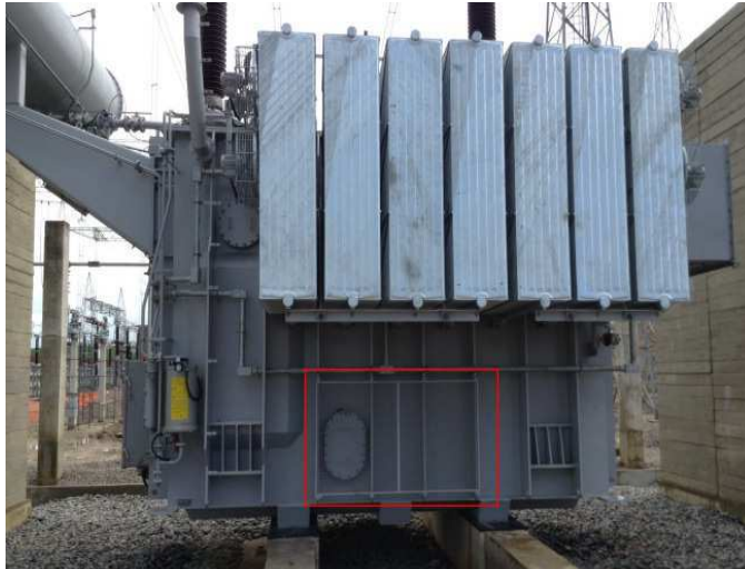
Figura 5. 10– Proteção em área de autotransformador monofásico 550/\sqrt{3} - 230/\sqrt{3} kV – 100 MVA (Fonte: Chesf)
