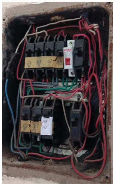
Figura A. 14: QD1 do bloco administrativo sem a tampa de proteção para verificação da fiação.
