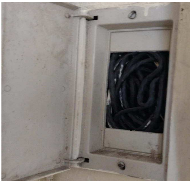
Figura A. 17: Caixa de passagem situada no pavimento superior.
