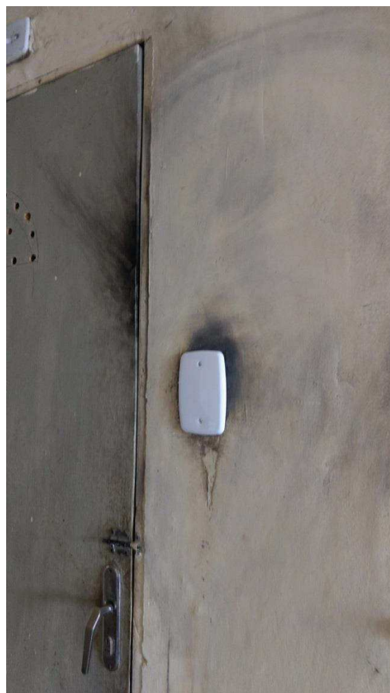
Figura A. 9: Resquício de início de incêndio.
