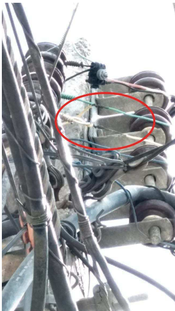
Figura A. 8: Condutores sem isolamento.
