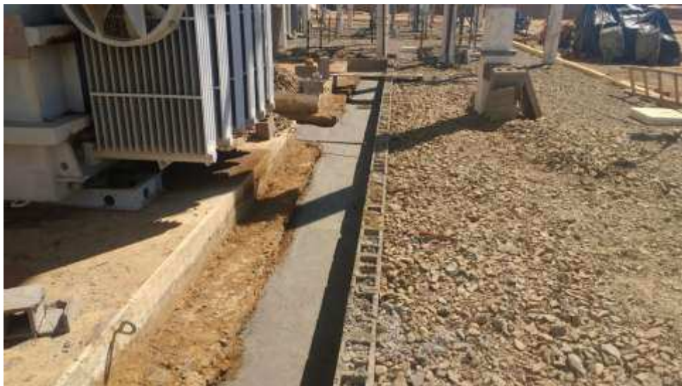
Figura 8 – Bacia Coletora de Transformadores
