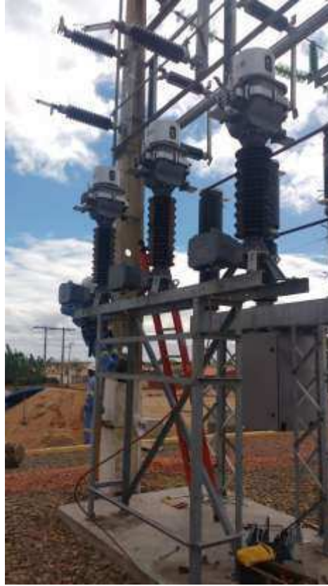
Figura 10: Bay de Proteção de 68 KV
