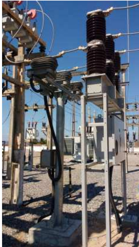
Figura 15 – Bay de Proteção de 15 KV
