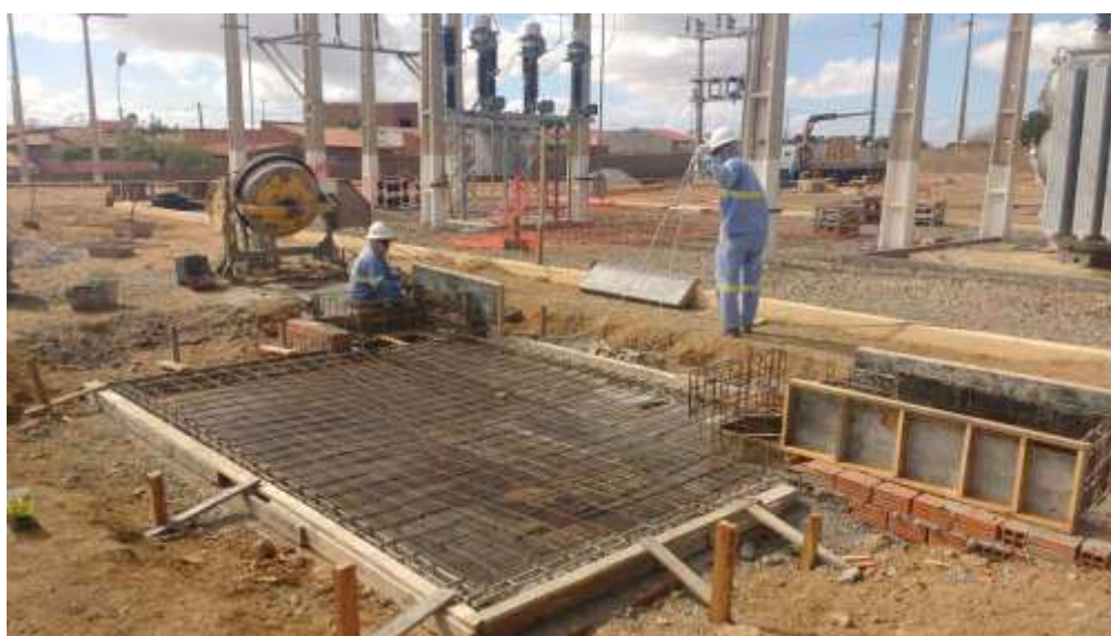
Figura 5 – Caixa Separadora de Água e Óleo
