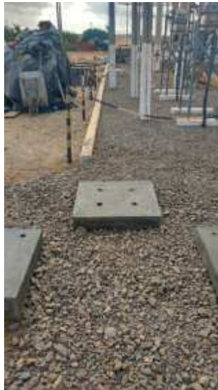
Figura 6 – Base de Disjuntor e TC de 15 KV
