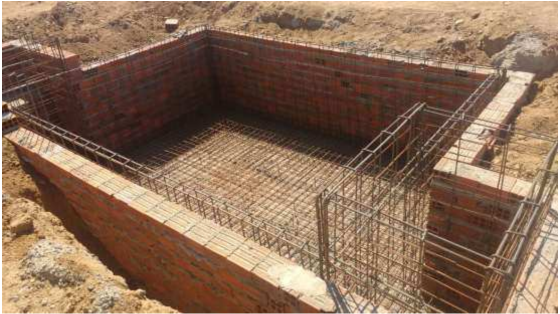
Figura 7 – Ferragem de uma Caixa Separadora
