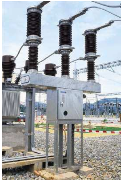
Figura 12 – Disjuntor Schineider de 69KV
