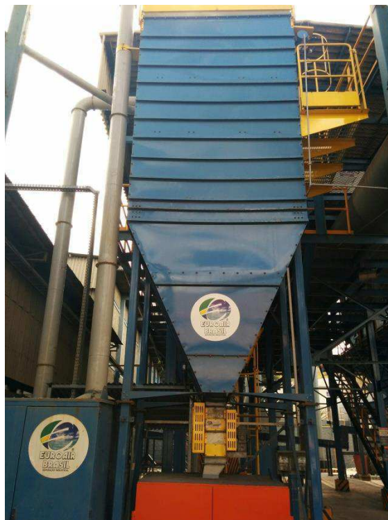
Figura 15 – Filtro do Sistema à Vácuo.
