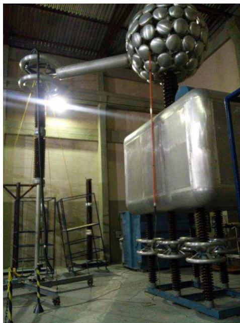
Figura 1 - Salão de alta tensão.
